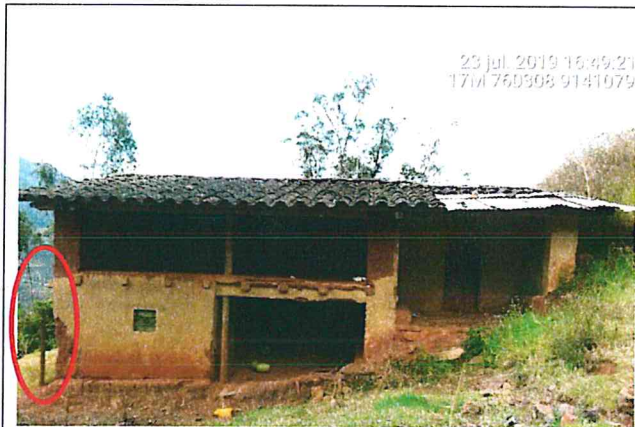
Foto N° 15: Se observa vivienda con material de adobe y techo de teja en mal estado de conservación
