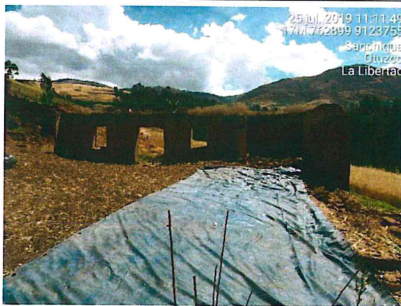
Foto N° 11: Vivienda colapsada, solo queda en pie la fachada de material de adobe.
