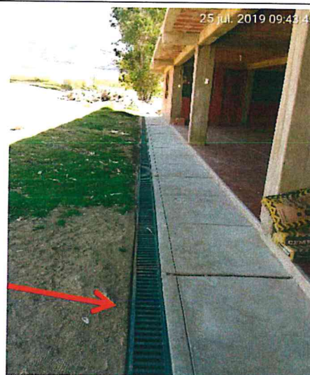
Foto N° 18: Se aprecia un sistema de drenaje contra las lluvias alrededor del Local Comunal.
