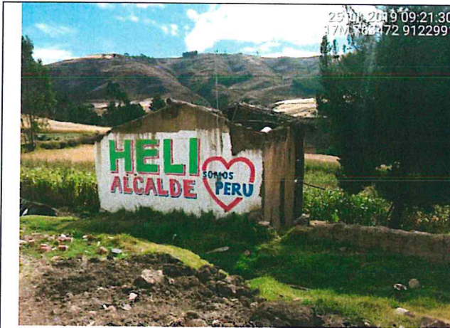
Foto N° 07: Vivienda de adobe sin tejado en las afueras de CP Sanchique. Ha colapsado el techo.
