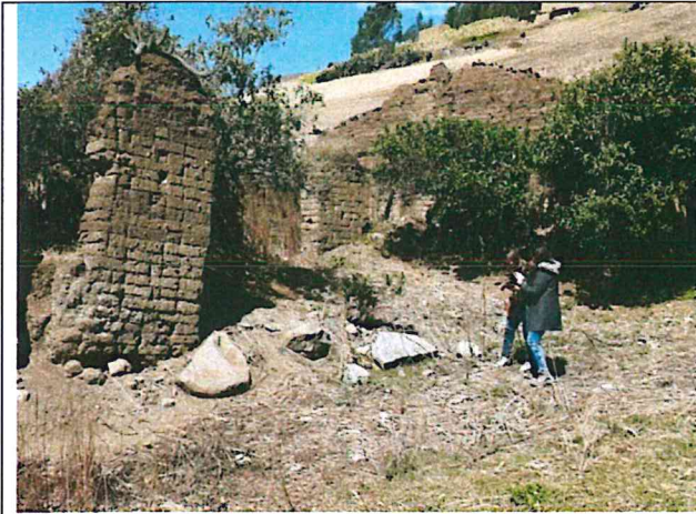
Foto N° 25: Se observa vivienda con paredes de adobe y techo colapsado completamente.
