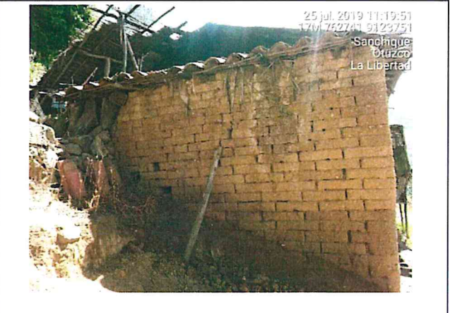
Foto N° 28: Pared de adobe de una vivienda en mal estado apoyada por palos de madera, para que no colapse. Cuenta con techo de tejas.
