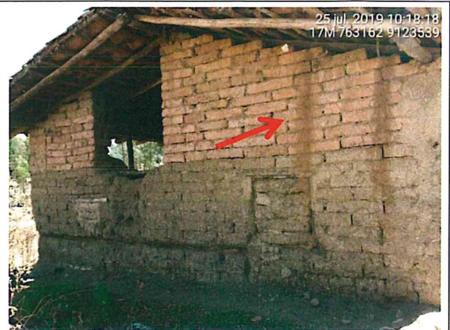
Foto N° 26: Vivienda de adobe en mal estado con los cimientos debilitados y se aprecia huella en las paredes de la infiltración por lluvias.
