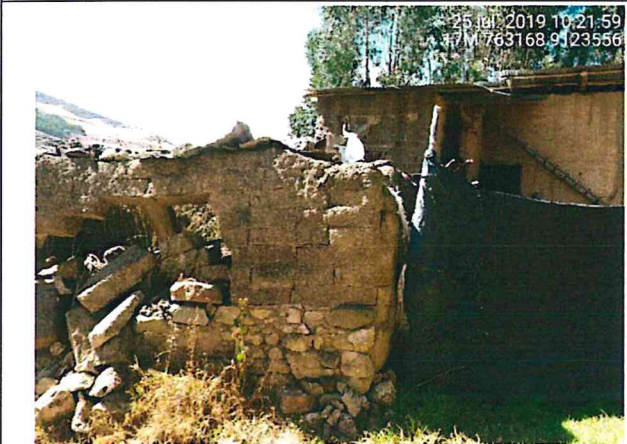
Foto N° 27: Vivienda de adobe en mal estado con la fachada parcialmente destruida.
