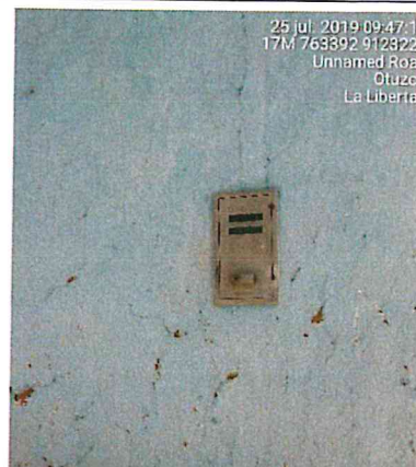
Foto N° 14: Se observa servicio de luz definitivo en las viviendas.
