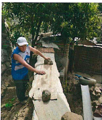
Foto N° 23: Muro de adobe inestable, cubierto con pedazos de calamina y bolsas plásticas para no que se humedezca ante las lluvias y defensa ante la activación de la Qda. Seca.
