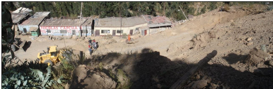
Vista hacia abajo del Tramo de la carretera y viviendas afectadas por el deslizamiento de tierras.
