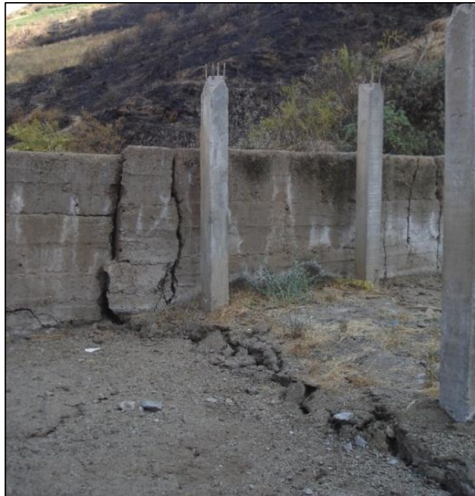
Cobertizo de ganado, con fuertes agrietamientos en el piso y muros.
