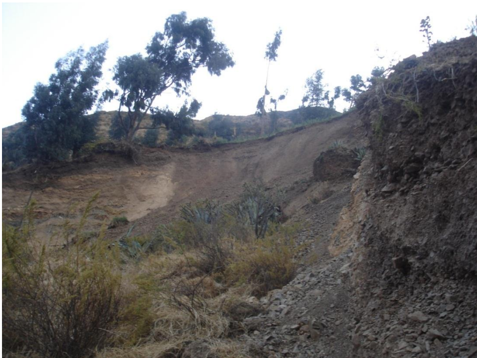
Vista de cerca de la zona de arranque del deslizamiento del 16/08; se aprecia el tipo de material, la pendiente del terreno.
