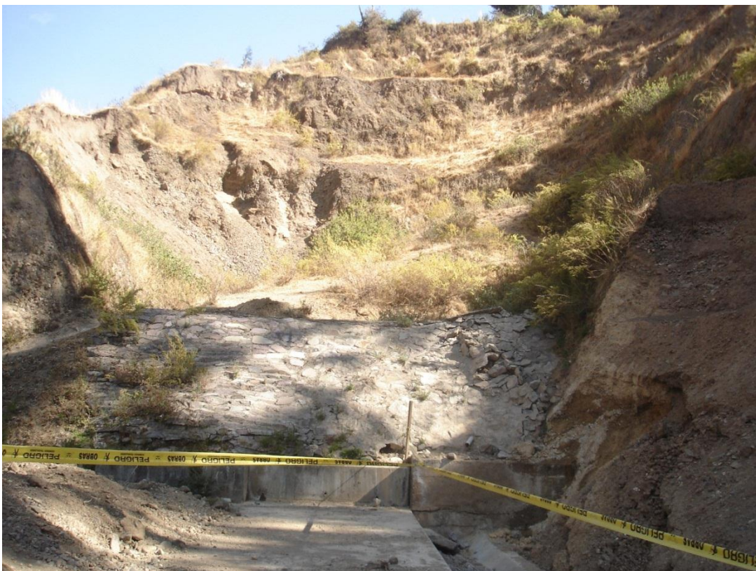
Túnel de entrada, canal de aducción. Se aprecia que parte de la pared o cubierta ha reventado por el empuje de la ladera; hay filtraciones o emanaciones de agua (A)
