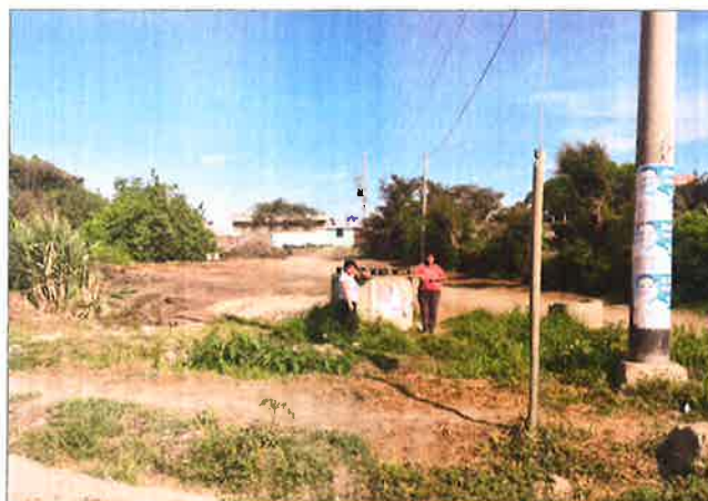
Figura 3: Pozo desde donde se bombea agua hacia reservorio de almacenamiento
