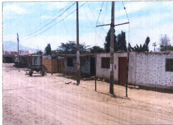
Figura 4: Postes de alumbrado público y acometida domiciliaria
