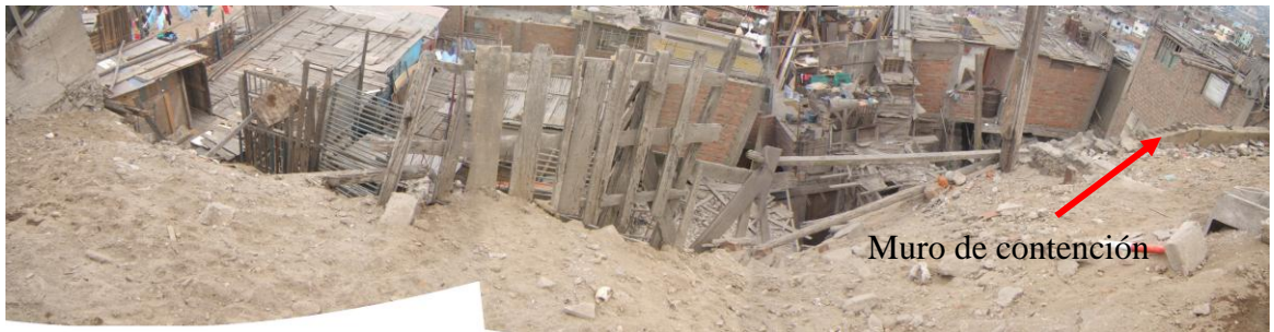
Foto 1.- Zona inestable, de donde se puede generar el derrumbe.
