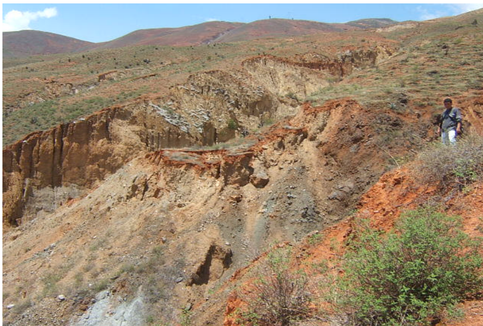
Foto N° 23 Deslizamiento en la cárcava izquierda de la quebrada La Florida. Saltos de terreno recientes en forma transversal a la cárcava principal.
