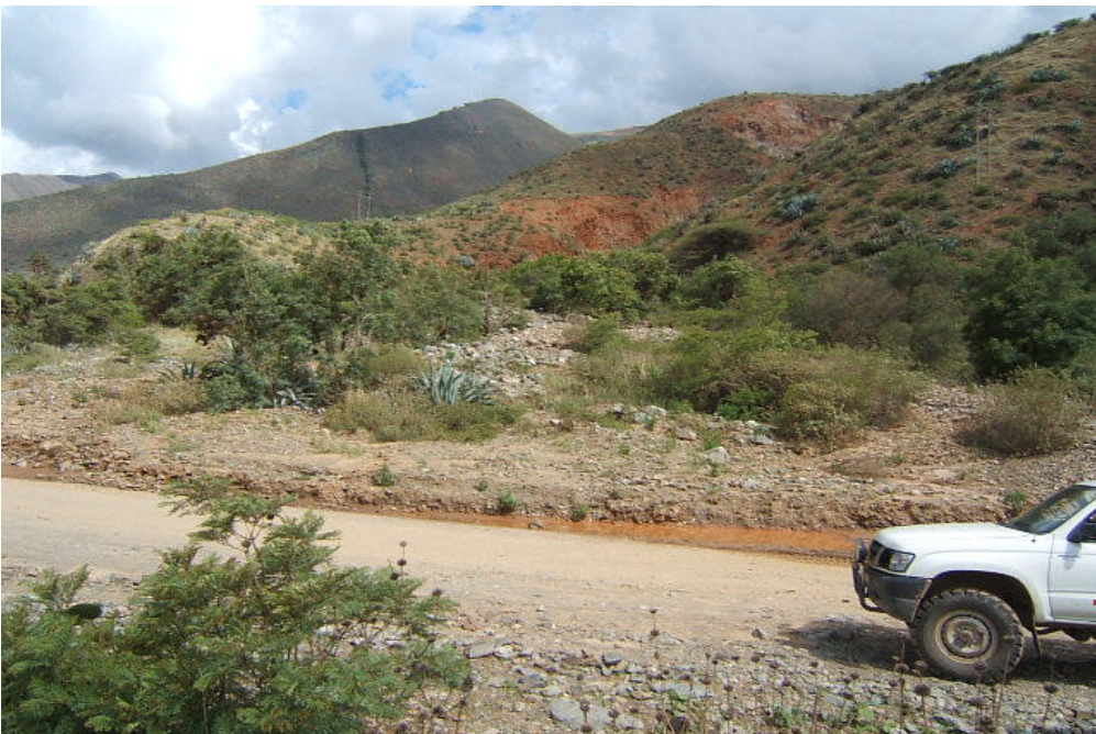
Foto N° 38 Tramo de la carretera Huánuco-La Unión frecuentemente afectada por huaycos que interrumpen el tráfico normal.
