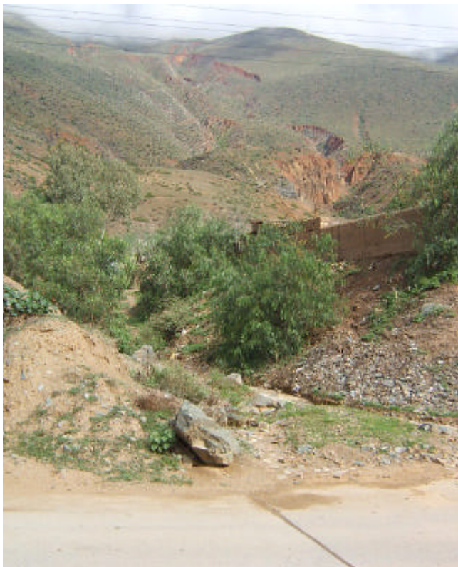
Foto N° 35 Material de huayco en el badén sobre la carretera al Aeropuerto.
