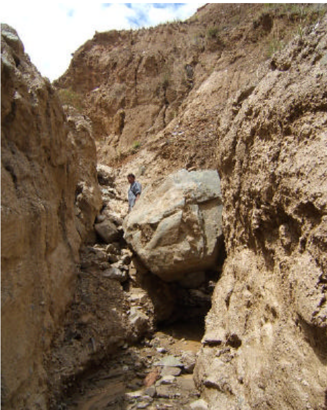
Fotos N° 28 y 29 Vista del sector medio de la quebrada La Florida (cárcava derecha), donde se puede apreciar material de un huayco reciente en las paredes y fondo del cauce, así como su naturaleza. Este material podría ser removido o arrastrado con una lluvia fuerte. En este sector existe un área inestable grande (deslizamientos), que podría ser incorporada, generando un flujo de gran dimensión.
