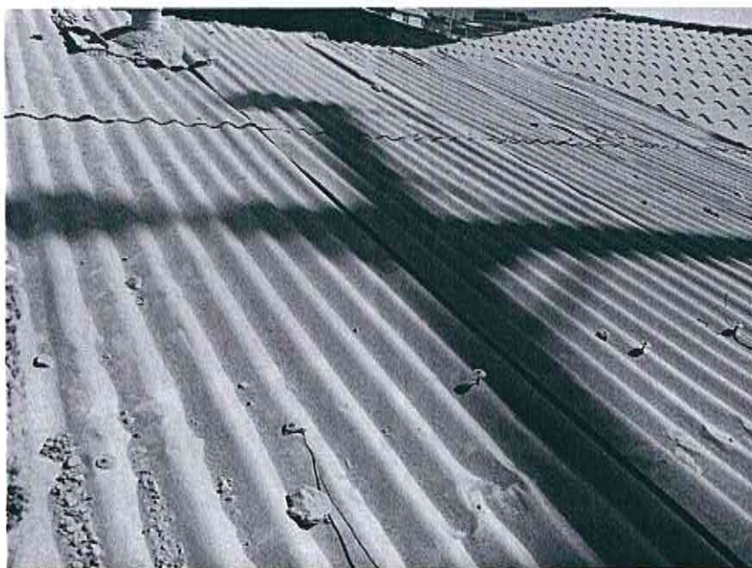
Foto 20: Se observa la ceniza sedimentada en los techos de las viviendas en la zona de Chojata, no se realizó campaña alguna de limpieza de techos, vista tomada el 28 de mayo del 2014.
