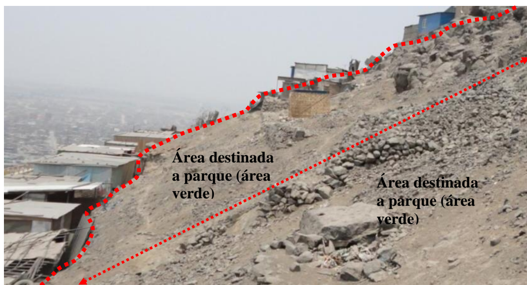
Foto N° 10.- Ladera del AA.HH., muestra rocas sueltas.
