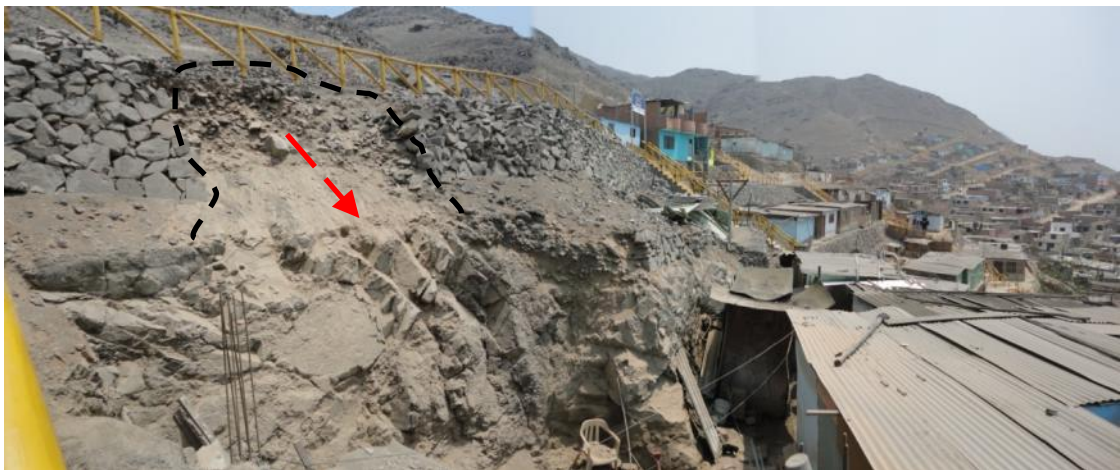
Foto N° 9.- Colapso de pirca de la vía de acceso, por la ampliación de vivienda.
