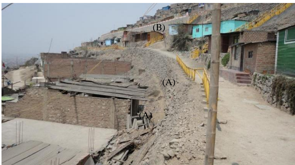
Foto N° 8.- Acceso construido a base de empicado, con altura hasta de 1,50 m (A), hacia la parte superior se observa un muro de contención (B).
