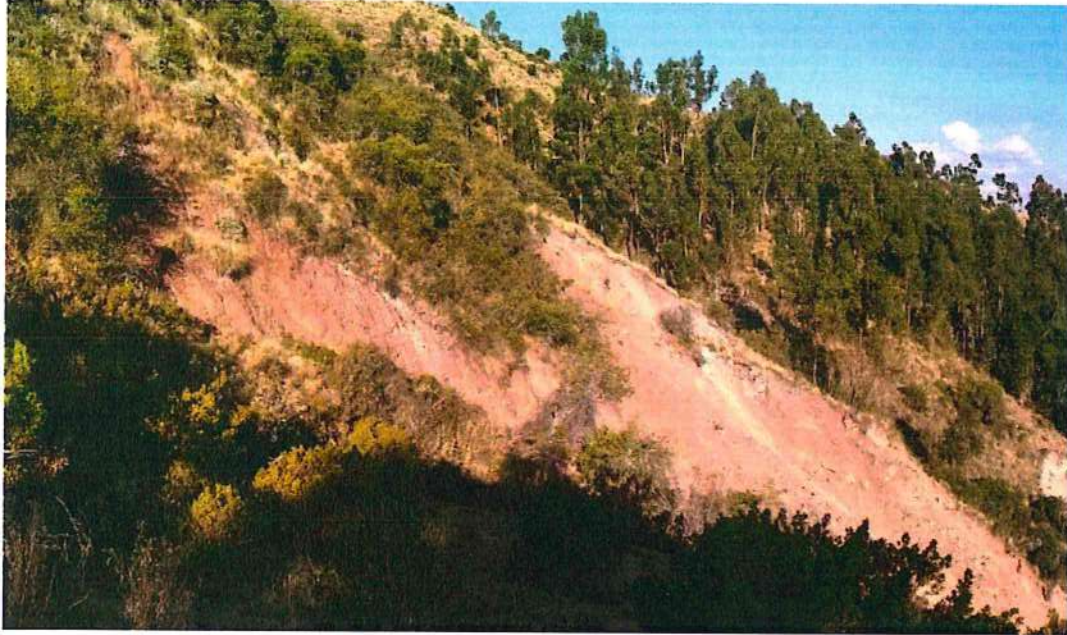
Fotografía 8. Escarpe principal del deslizamiento traslacional
