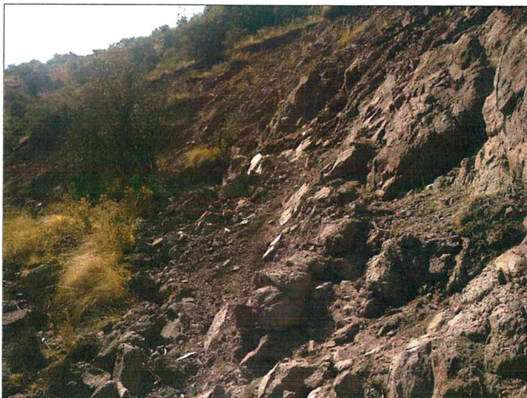
Fotografía 10. Zona de derrumbes, se observan bloques sueltos suspendidos
