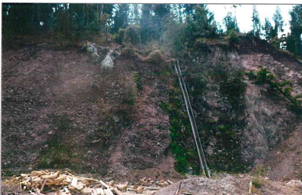
Fotografía 6. Canal de drenaje, situado en el flanco derecho del deslizamiento, el canal aún se mantiene conservado
