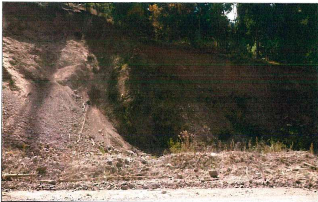
Fotografía 4. Material depositado al pie de talud
