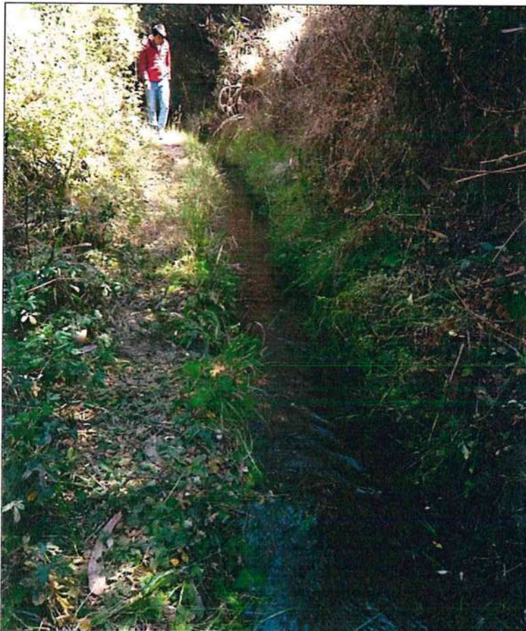
Fotografía 14. Canal de riego sin revestir de la comunidad de Aransaya, está generando infiltración de agua al terreno, dejándolo húmedo y muy susceptible a la reactivación de deslizamientos
