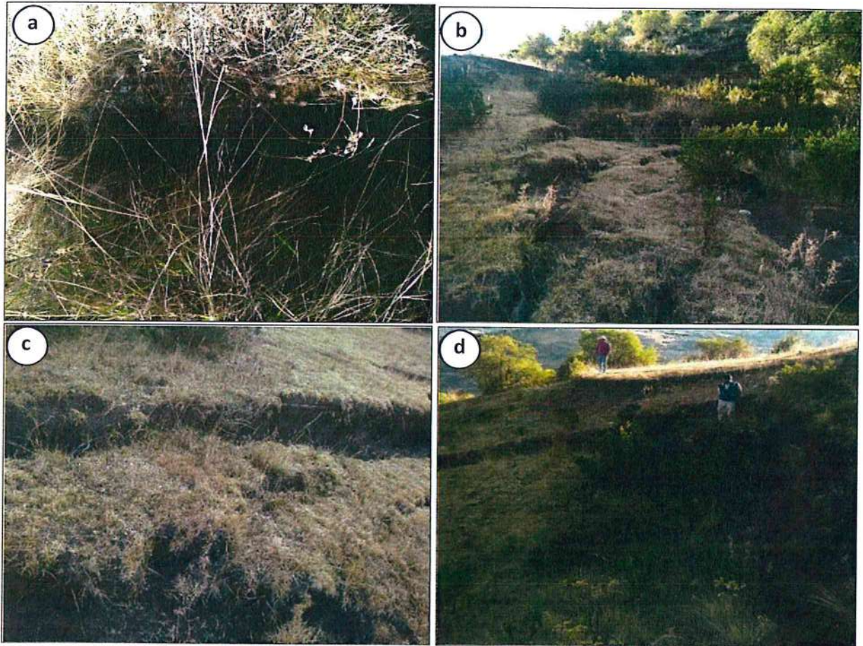
Figura 13. Agrietamientos tensionales, ubicados en el cuerpo del deslizamiento reactivado a) Zona de agrietamientos en el flanco izquierdo del deslizamiento b) Agrietamientos en el cuerpo del deslizamiento, se formaron tipo basculamiento c) Cabecera del deslizamiento reactivado, muestra salto de 0.5 m d) Escarpe del deslizamiento reactivado
