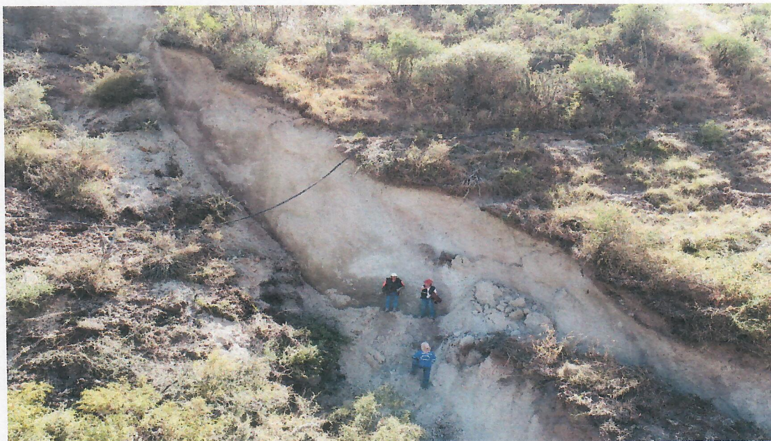
Imagen 08: Fotografía aérea Drone, vista de la Escarpa Principal (zona de deslizamiento=8m), un inadecuado uso de sus aguas, observando tubos de agua que podrían desencadenar de una manera más rápida la Estabilidad del Talud. Fuente: Equipo Técnico GRD.
