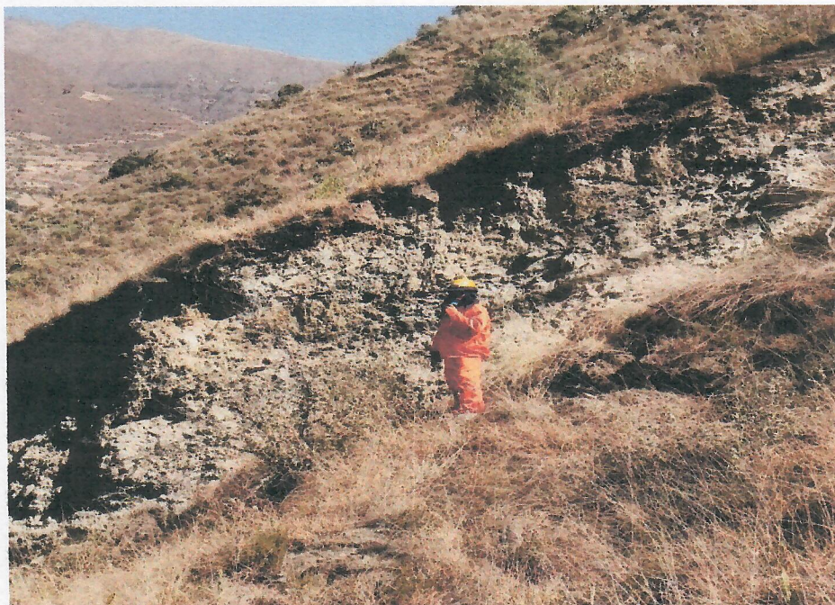
Imagen 04: Fotografía, altura de deslizamiento= 8m y presencia de grietas = 10 cm en suelos Limo Arcillosos y Rocas Metamórficas Alteradas (NP-cm-gn,esq,metsed) Fuente: Equipo Técnico GRD.
