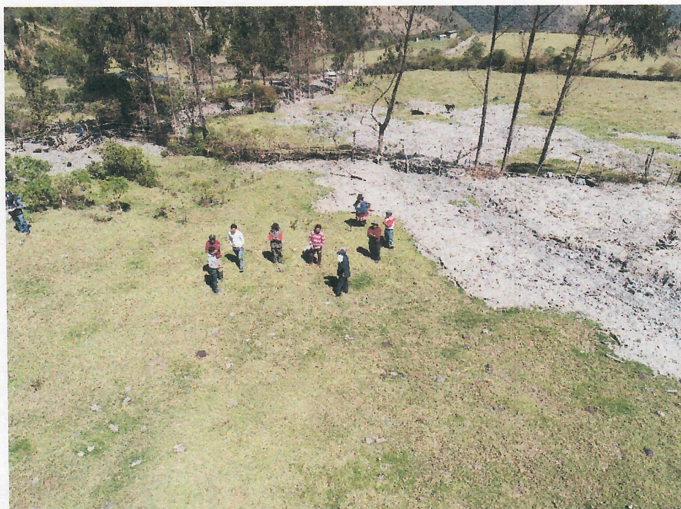
Imagen 22: Flujo de detritos en la quebrada Mamacchuma
