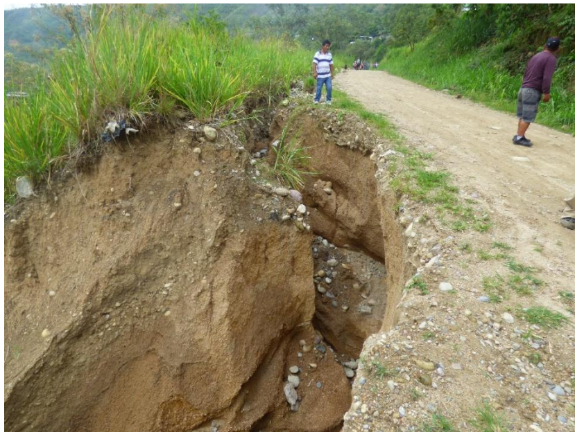
Fotografía 6. Se parecía un proceso de erosión de ladera reciente, en la vía de acceso al cerro San Genaro.
