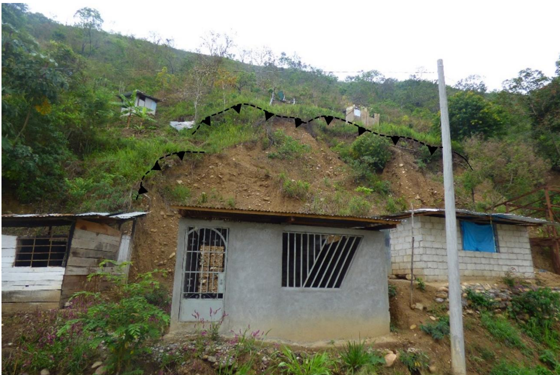
Figura 13. En la parte posterior de las viviendas, se están formando algunos escarpes, señalados con la línea negra discontinua.
