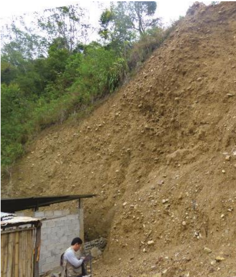
Fotografía 2. Corte de talud con una altura de hasta 8 m, realizado para la construcción de vivienda.
