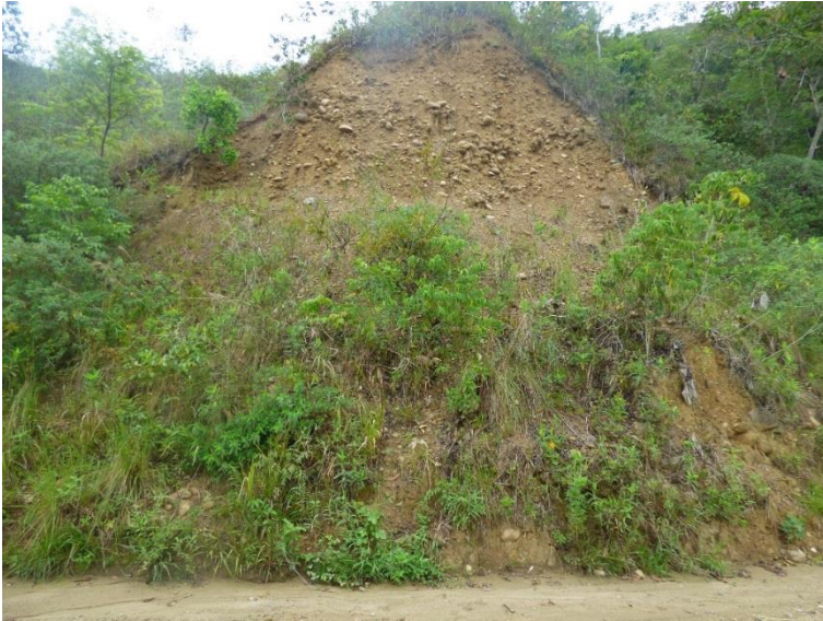
Fotografía 1. Corte de talud para carretera, sector inestable.
