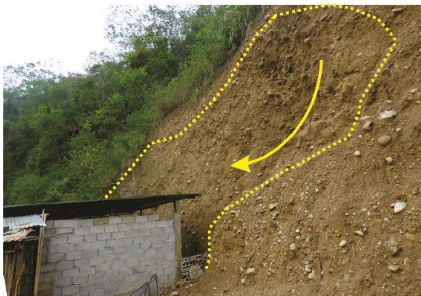
Figura 18. Se muestra un deslizamiento local, generado por el corte de talud.
