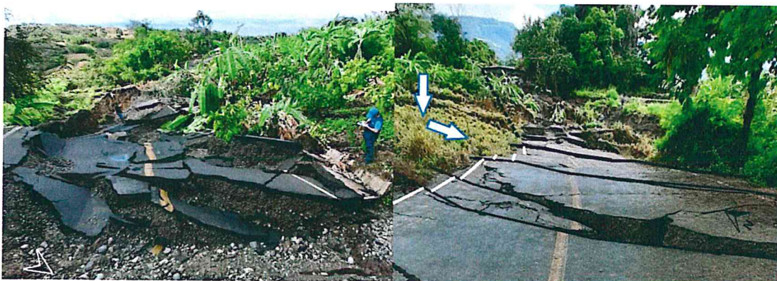
Figura 27. Vía asfaltada con grietas longitudinales que han formado pequeños escarpes escalonados.
