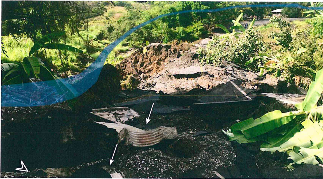
Figura 42. Canal y alcantarillas de la quebrada Naranjos totalmente destruidos.
