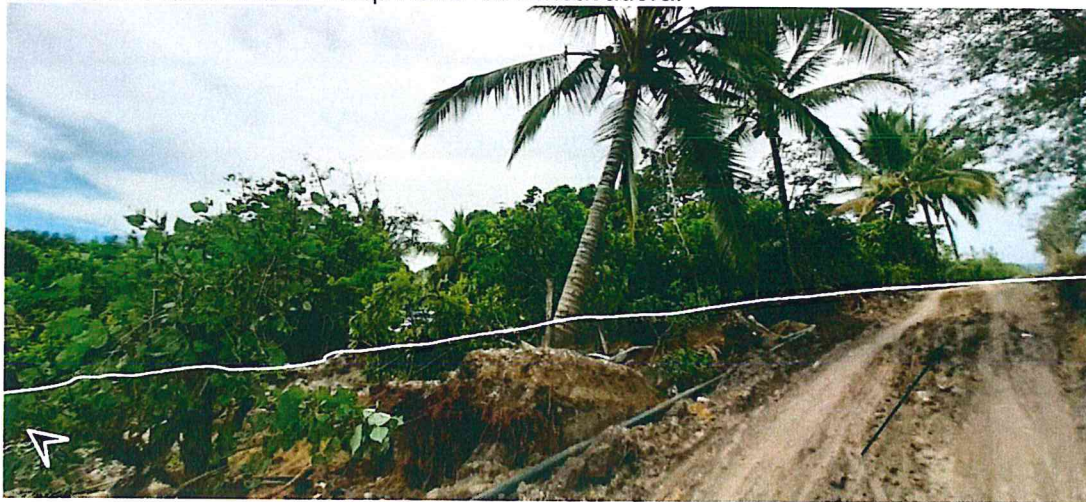
Figura 41. Corona y escarpe del deslizamiento que afecto la vía hacia Diamante Alto.
