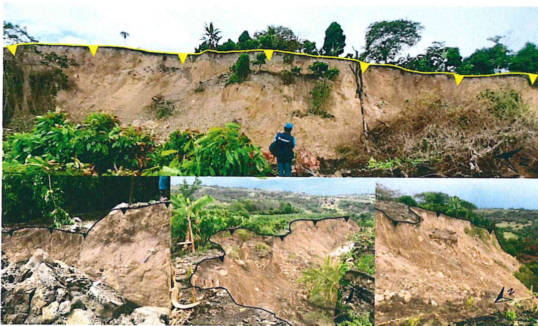
Figura 25. Vistas del escarpe principal del deslizamiento con diferentes alturas.
