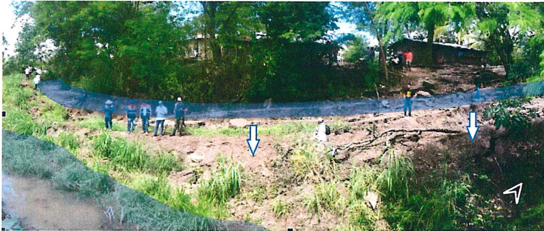
Figura 38. Vista del Canal Naranjos, subsidencia y desplazamiento latera.
