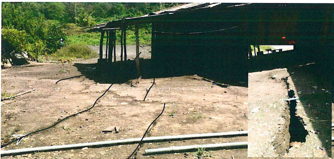
Figura 43. Grietas longitudinales de hasta 20 cm de ancho y 50 m de largo.
