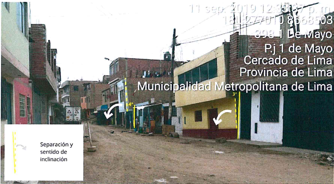
Figura 22 Inclinación de viviendas por hundimiento en el asentamiento Primero de Mayo
