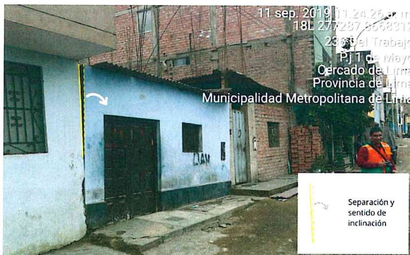
Figura 16 Inclinación de viviendas por asentamiento en la Av. del Trabajo del asentamiento humano Primero de Mayo
