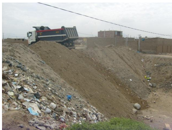
Imagen 14: Relleno de la ocupación informal - Sector las Brisas
