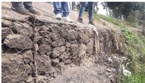
Se observo gaviones antiguos cubiertos por la vegetación, tierra y residuos solidos (margen izquierda del rio).
