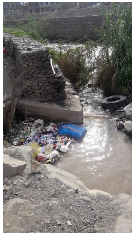
Bocatoma en la margen izquierda obstruida por residuos solidos y vegetación.
