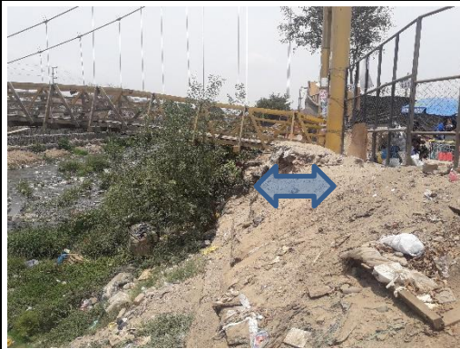
Se observa acumulación de desmonte invadiendo cauce del río respecto al estribo en la margen izquierda del puente.
