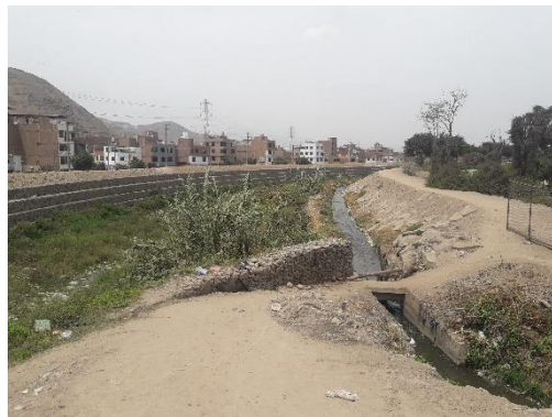
Se observa una bocatoma precaria en la margen izquierda sin compuerta de control. Probable punto de desborde en caso de una crecida súbita del caudal.
