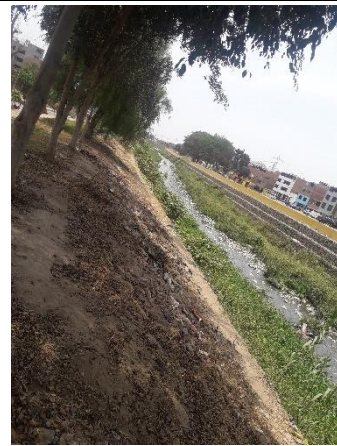
Se observa desde la parte alta de la margen izquierda los gaviones antiguos cubiertos por la vegetación.
