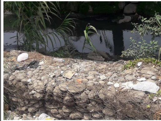
Gaviones antiguos no tienen altura suficiente para soportar una crecida inusual y evidencian falta de mantenimiento.
