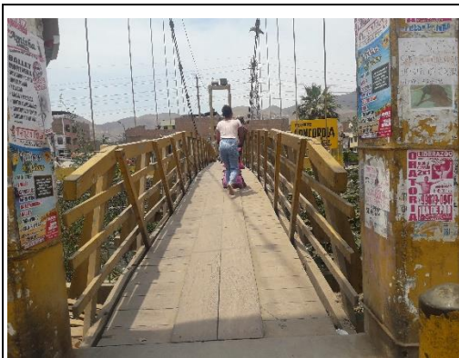
Puente peatonal sobre el río Chillón presenta maderamen debilitado por falta de mantenimiento. (Puente Bethania).
