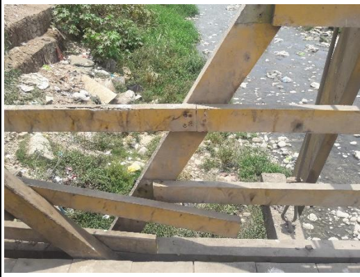
Pasos de madera debilitados y parte de la baranda deteriorada por falta de mantenimiento.
