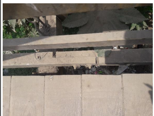
Pasos de madera debilitados y parte de la baranda deteriorada por falta de mantenimiento.
