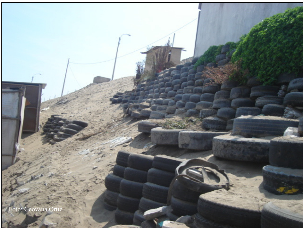
Foto 8.- Pared formada por llantas superpuestas, con la finalidad de estabilizar el talud.
