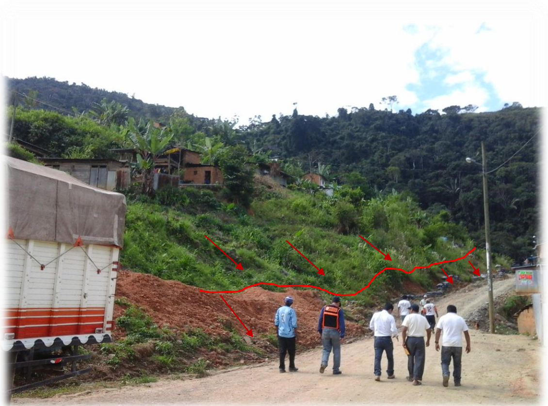
Foto N° 01: Dirección del deslizamiento ocurrido en el Barrio Selva Alegre.
