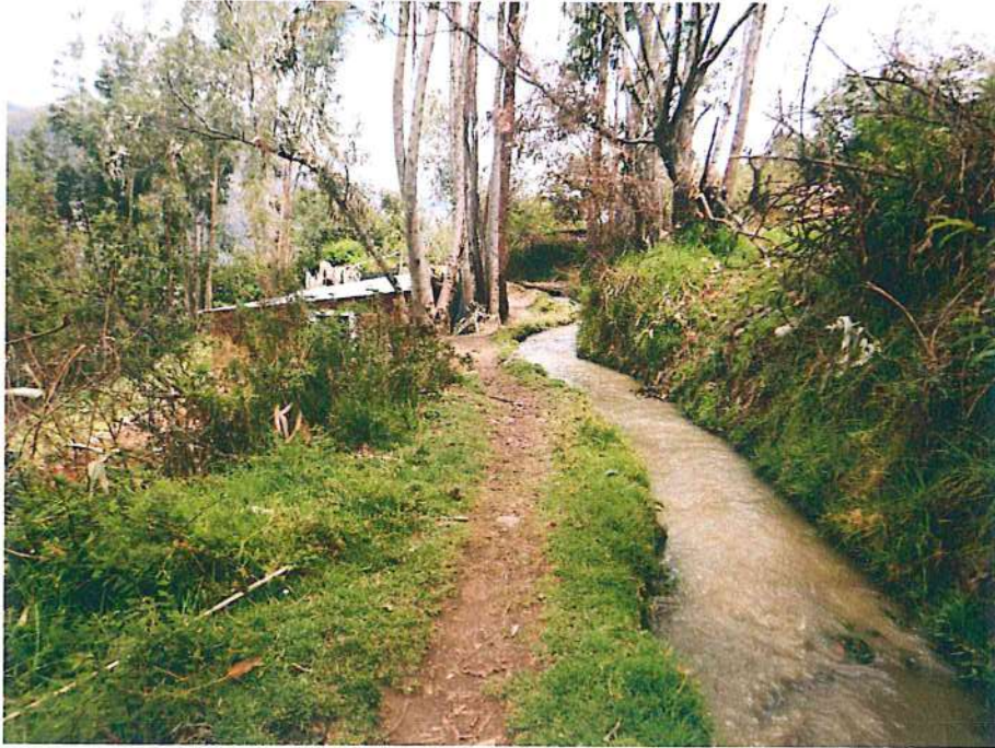
Fotografía 9. Vista donde se puede observar el canal de regadío sin revestimiento,
