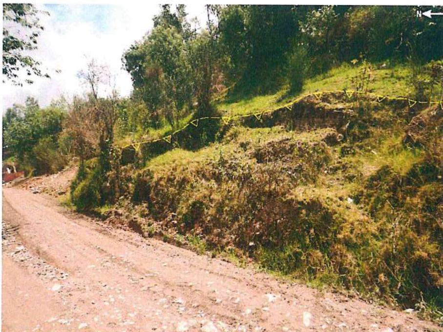
Figura 11. Se observa un escarpe secundario del deslizamiento antiguo. Trocha carrozable de Anantigua – Pumararra.
