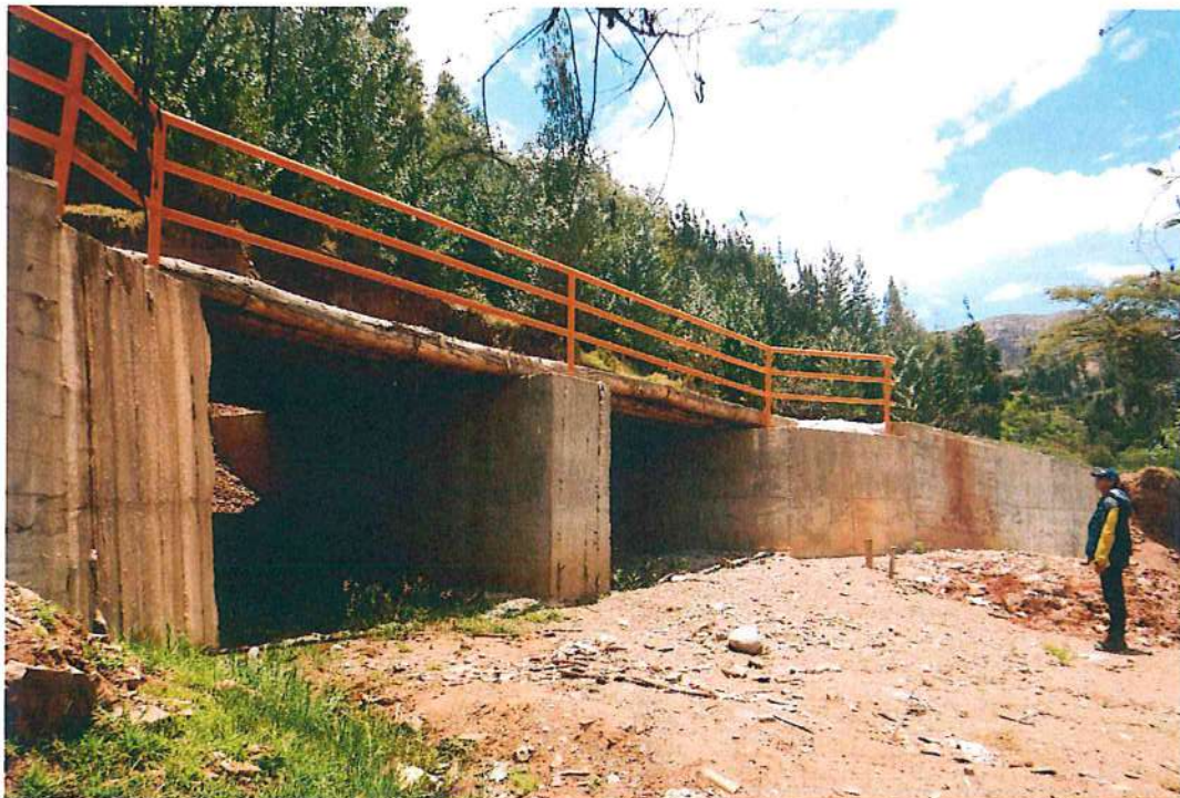
Fotografía 4. Se observa muro de contención de concreto, con un puente provisional a base de tronco de madera, el que permite el tránsito vehicular. Los ojos de luz de dicho puente permiten drenar el agua que discurre de la ladera.
