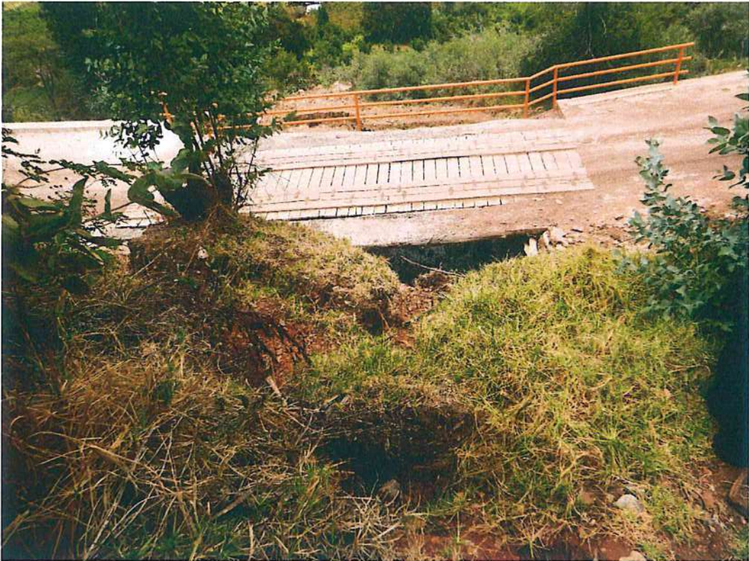
Fotografía 5. Vista tomada a partir de las siguientes coordenadas UTM 8979862 N, 205156 E, con una cota de 2584 m.s.n.m. se observa que parte del deslizamiento se transporta bajo la luz del pontón, se observa arboles de eucaliptos inclinados.
