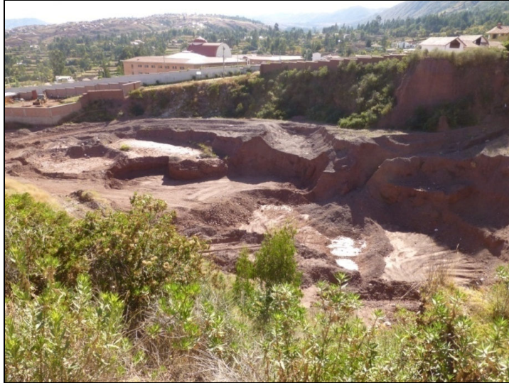
Foto 5.22 Disipador N° 02, donde el flujo de detritos fue retirado
