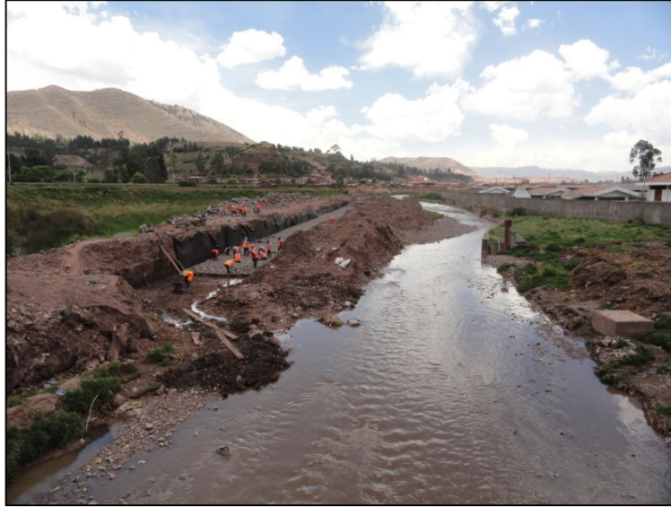
Foto 5.17 Acumulación de sedimentos en la zona de Kayra,
