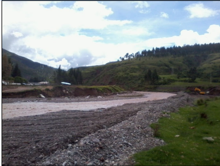
Foto 5.16 Sector de la PTAR de Seda Cusco, acumulación de material rocoso y sedimento
