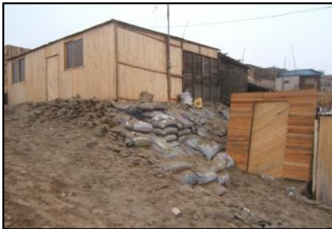
Foto 9.- Vista de una vivienda de la manzana "B". Se observa el mal estado de los ensacados de arena, al igual que el de los muros secos.
