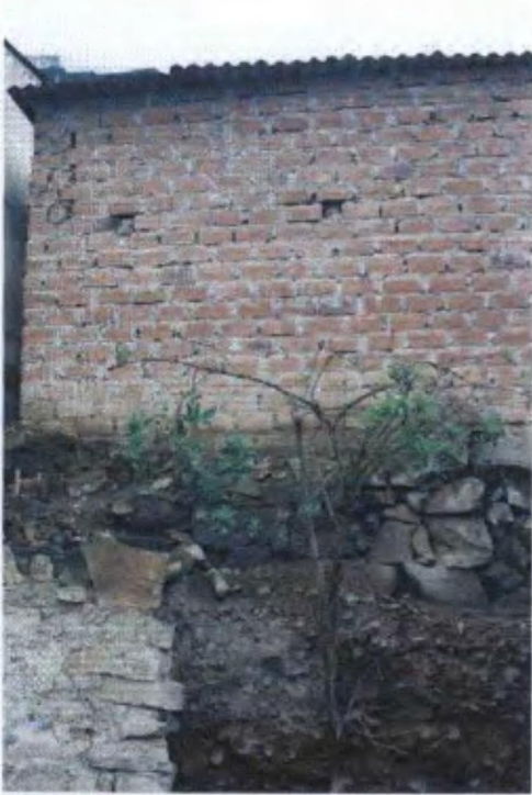
F 12. Vivienda de ladrillo sin columna, lote 7 / Mz A.
