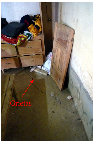
Foto 13: Grietas en paredes y piso de local comunal de Vista Alegre, por asentamiento en el terreno.
