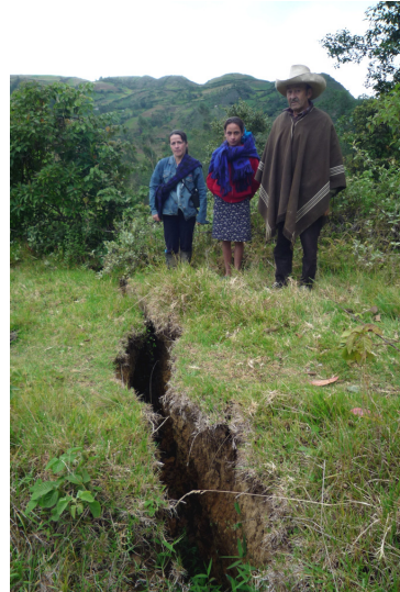
Foto 17: Grieta en el cuerpo del movimiento compuesto, por donde se infiltra fácilmente el agua.
