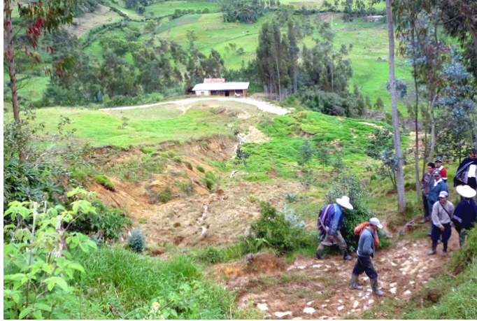
Foto 15: Vista ladera abajo, es posible observar el cuerpo alargado del movimiento en cual destruyo la carretera de acceso a Chiguirip y llego a represar una quebrada.
