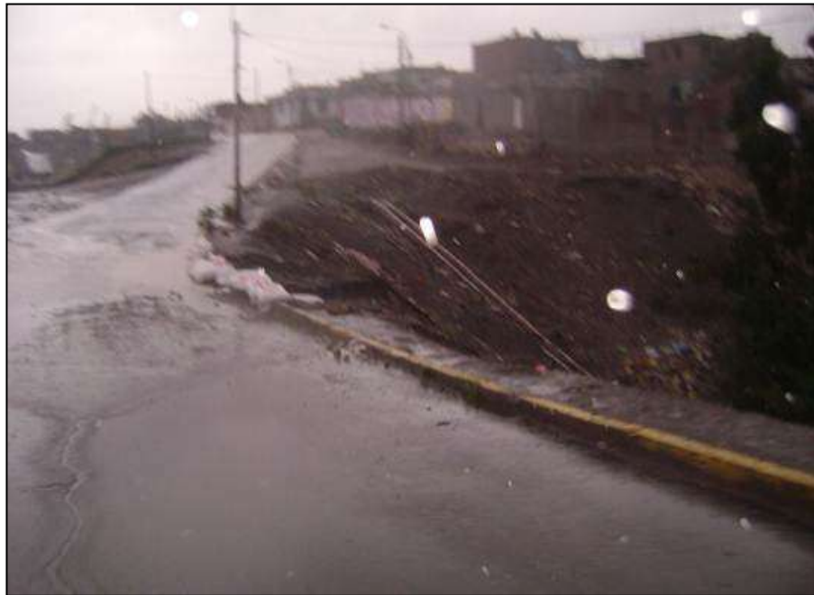
Fotos N° 13. Se observa el paso (Puente del Ejército) con agua inundada la cual muestra la falta de un buen sistema de drenaje.
