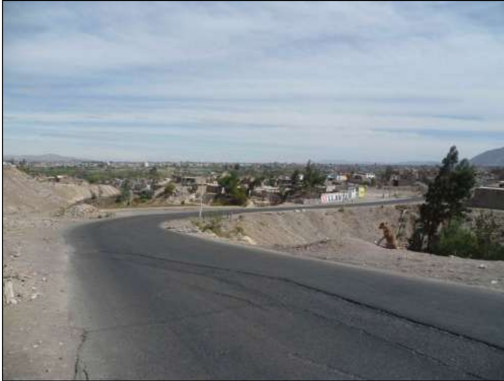
Foto N° 11. Carpeta asfáltica refaccionada, la cual ha sido afectada por el agua de escorrentía que lo ha erosionado (vía de acceso al Puente del Ejército).
