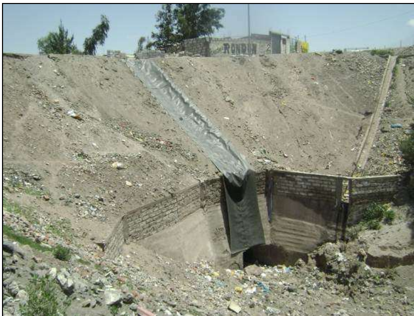
Foto N° 15. Talud norte al pie del cual se distingue la alcantarilla colmatada. Asimismo se distingue un drenaje provisional cubierto con una geomembrana para evitar descargar el agua de las lluvias y evitar la erosión del talud del terraplén.
