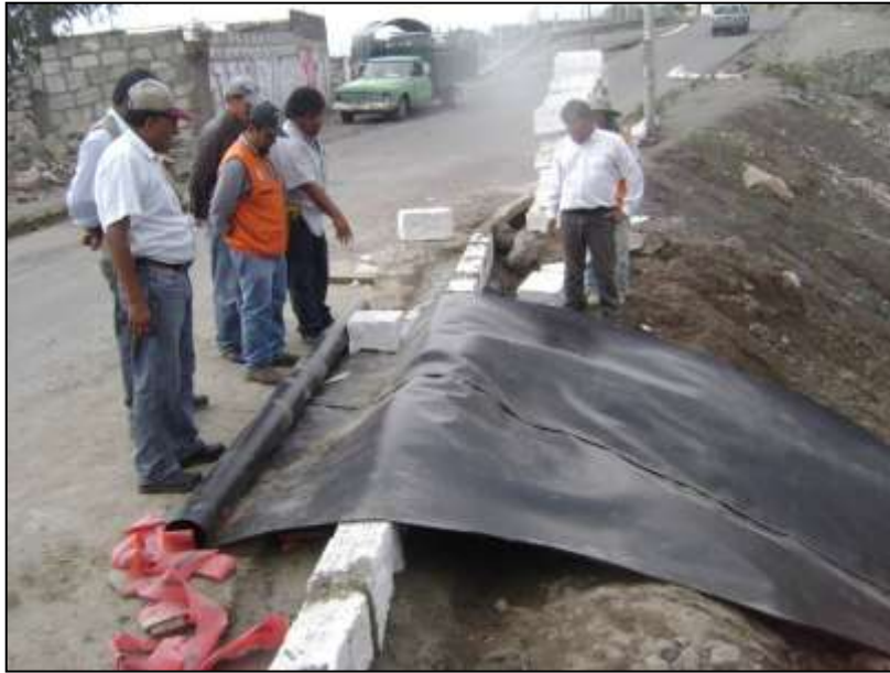
Foto N° 14. Se observa la vía dañada en la cual se desarrollan los trabajos de instalación de una geomembrana.
