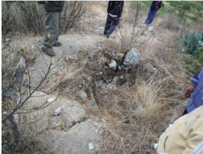
Foto 3: Abombamientos y hundimientos producto de la movilización del material del deslizamiento.
