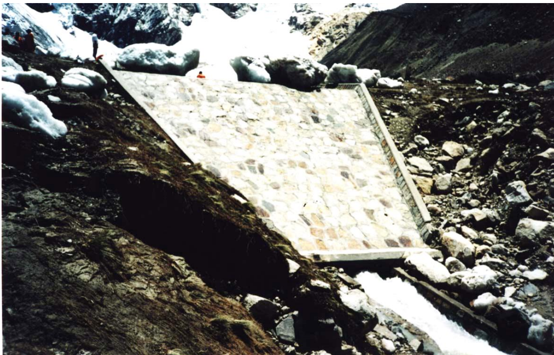
FOTO 12 : Talud interior de la presa, sobre ella los bloques de hielo, y el canal de salida trabajando a plena carga. Se observa también la erosión en las morrenas laterales, así como el desprendimiento de la mampostería del ángulo inferior izquierdo de la presa.
