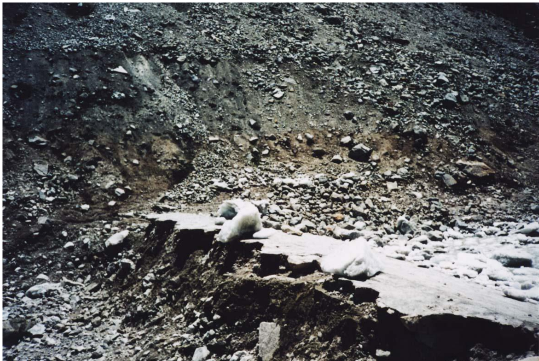
FOTO 14 : Talud exterior de la presa secundaria, totalmente erosionado, como consecuencia del desborde de la laguna. Esta es la estructura con mayores daños.
