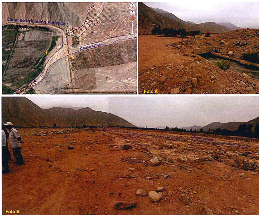
Figura 12. En la imagen satelital se muestra el canal del río Pativilca, en la foto (A) el canal cubierto, y en la foto (B) la parte erosionada.
