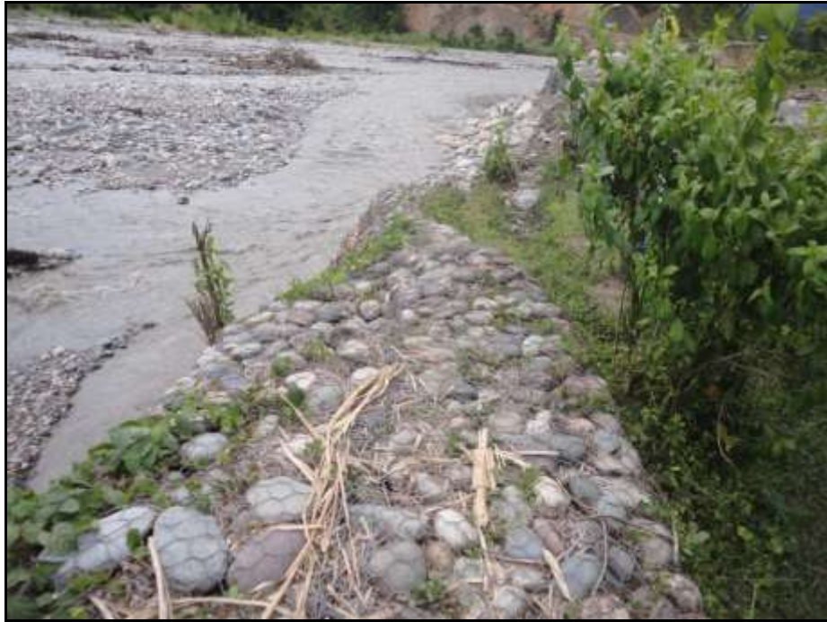
Foto 28.- Gavión afectado por la erosión lateral.
