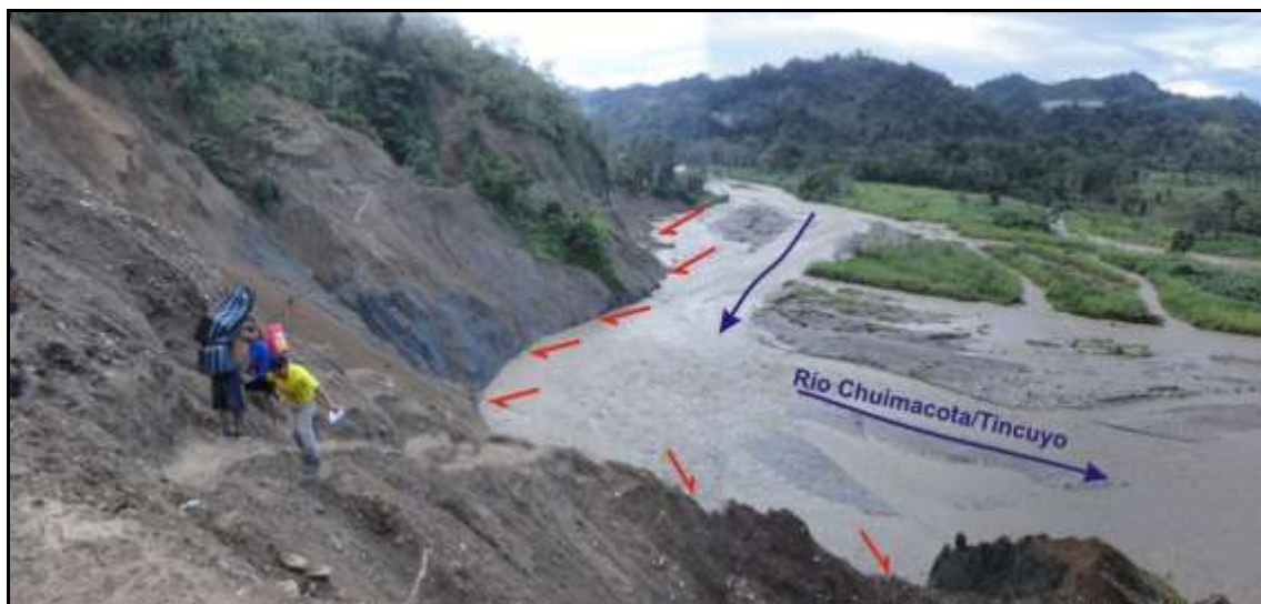
Foto 32.- Derrumbe del sector de Barranca, afectó carretera Llochegua-Chihuillo, se muestra el área inestable. Las flechas de color rojo indican el sentido de la erosión del río, las de color azul el sentido de corriente del río.
