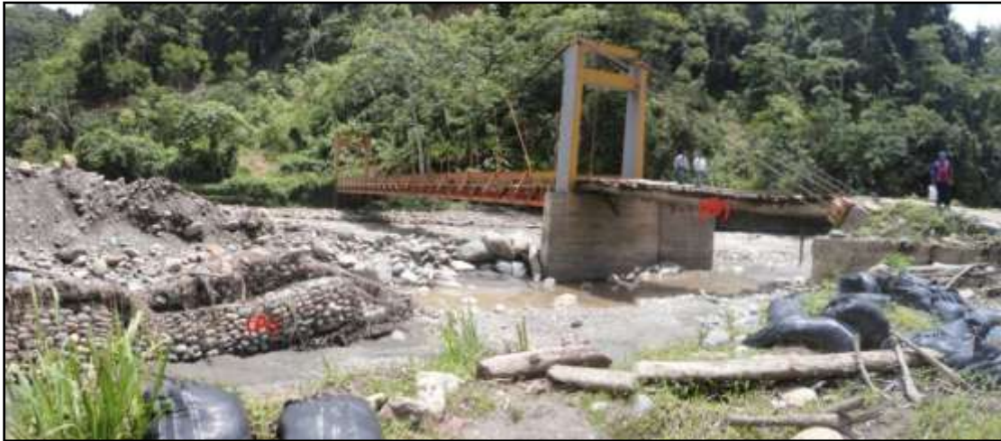
Foto 20.- Se aprecian defensas ribereñas destruidas (A). La rampa de acceso al puente por margen derecha completamente erosionada, se ha reemplazado por un puente de palos (B).
