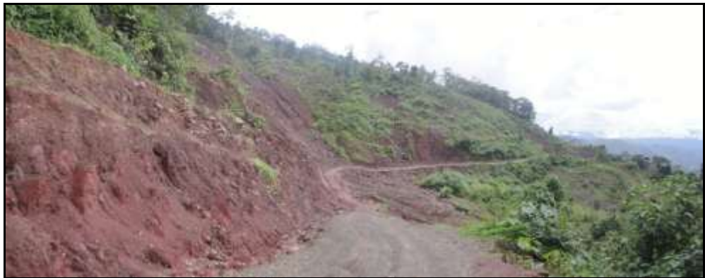
Foto 31.- Sector de Chola Naciente, se aprecia un derrumbe que afectó carretera afirmada Llochegua-Chola Naciente.
