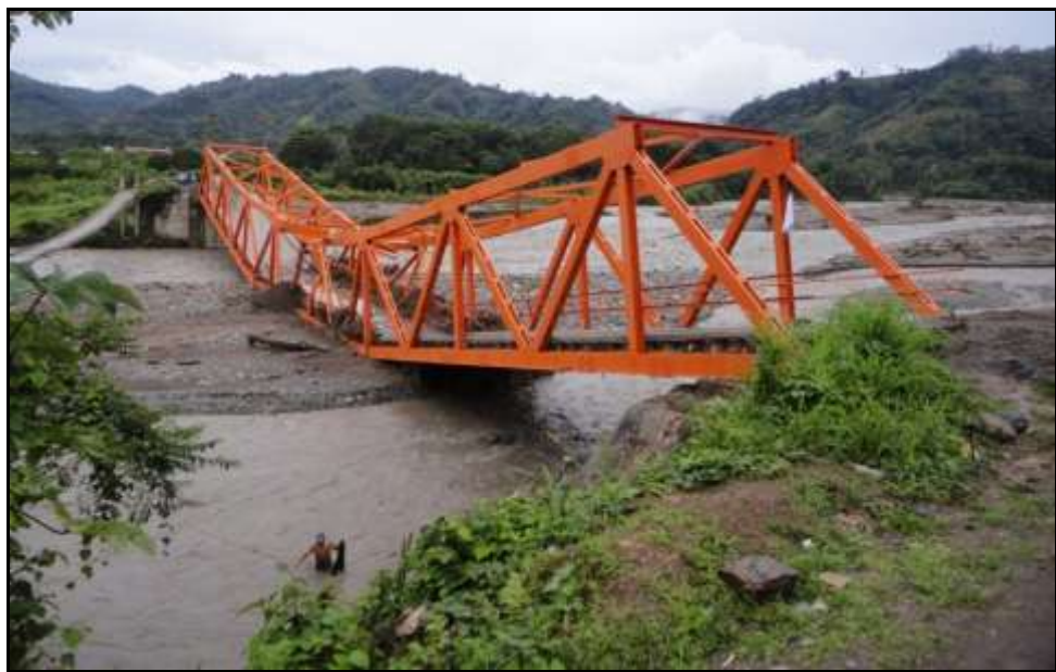
Foto 25.-. Puente Tincuyo, colapsó en el año 2010.
