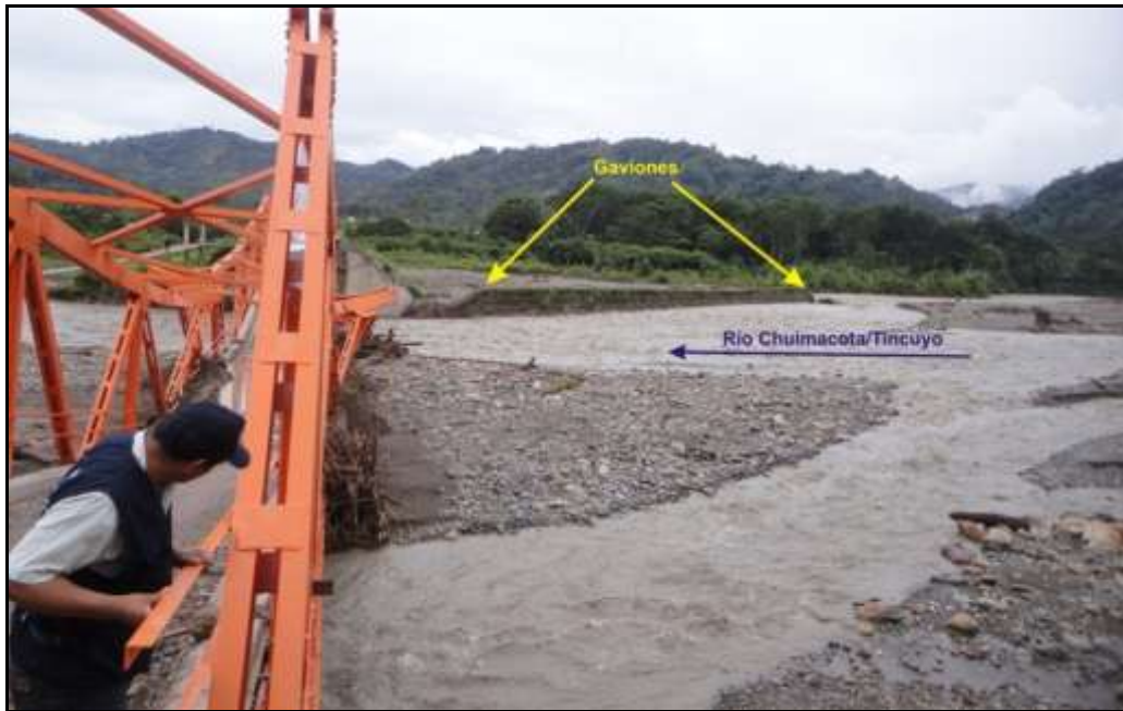
Foto 22.- Puentes Tincuyo colapsado, se aprecian en la margen derecha las defensas ribereñas (gaviones).
