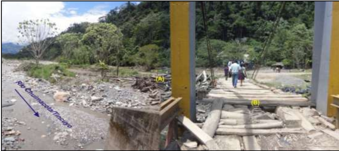
Foto 19.- Restos de troncos (A) dejados por la carga del flujo de detritos. (B) la rampa de acceso al puente destruida.
