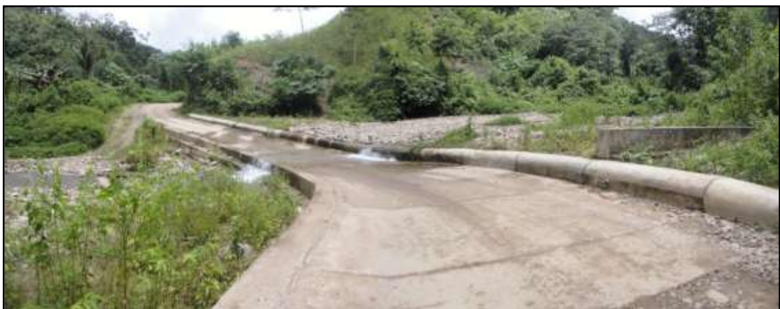
Foto 15.- Quebrada CharquiHuayco, con material suelto en el cauce de la quebrada.
