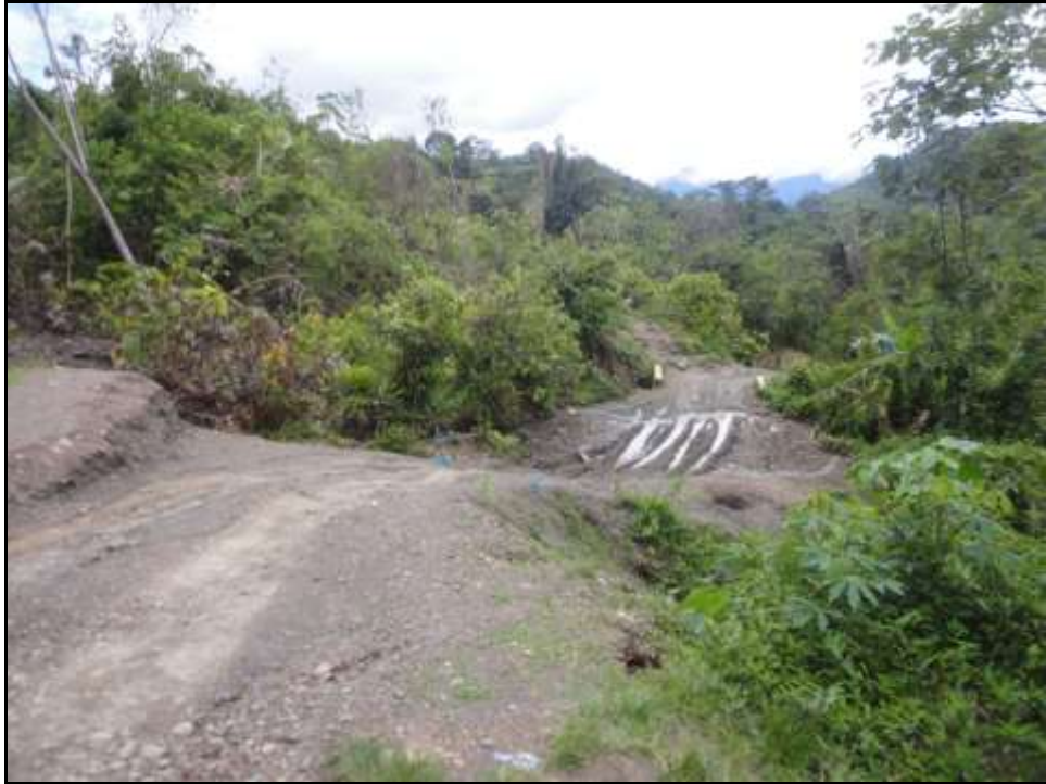
Foto 29.- Área inestable por deslizamiento, se observan asentamientos del terreno, que afectado a la carretera.
