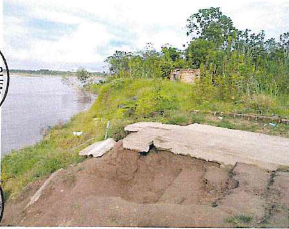
VEREDAD AFECTADA POR LA EROSION FLUVIAL
