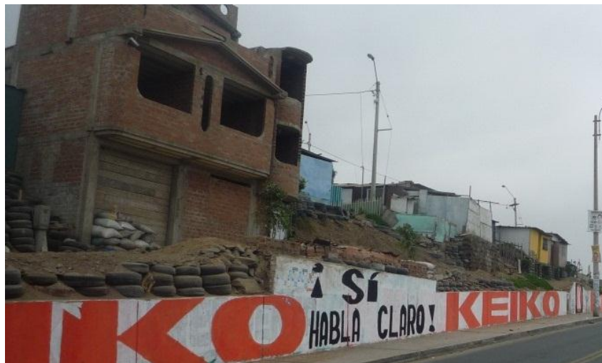
Foto 20. Av. María Reich, sector del A.H. Edilberto Ramos, se observan muros de contención de concreto y de llantas, para evitar el colapso del talud (casa de material noble de tres pisos). La pregunta es, funcionarían estas estructuras con sismo de gran magnitud.
