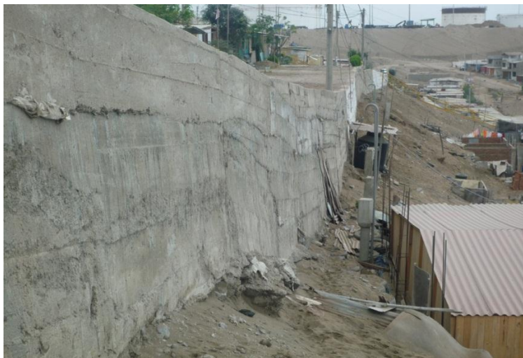
Foto 17. Sector Héroes del Cénepa, se observa el muro de contención, que su base está quedando inestable,
