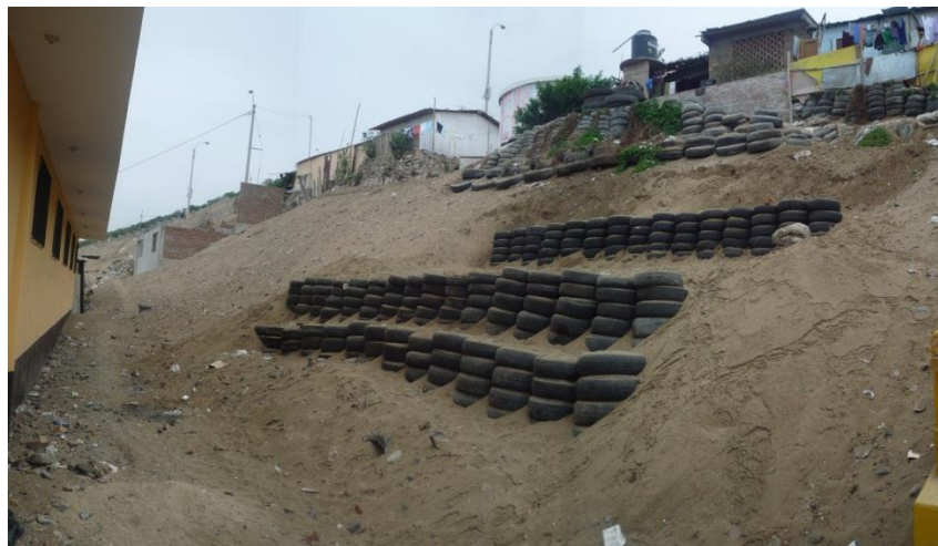
Foto 8. Sector Las Palmeras. Se muestra la inestabilidad de la ladera.
