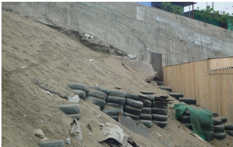
Foto 11. El muro está "flotando", detalle que muestra la inconsistencia de la arena y la inestabilidad del área.
