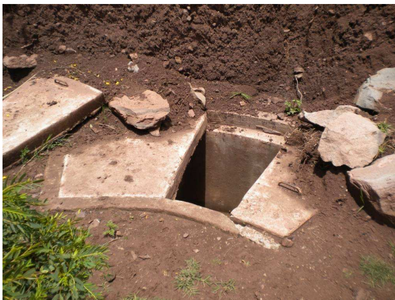
BUZON DEL CANAL DE IRRIGACION SAMBOR-HUAYPO
