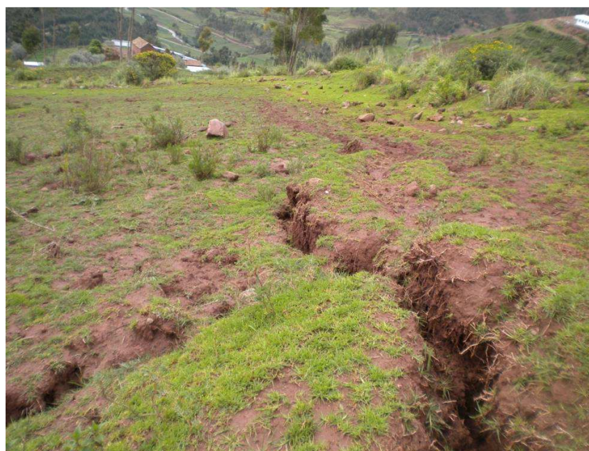
GRIETAS DE TENSION
