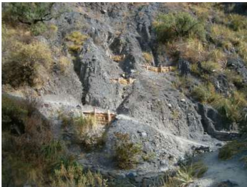
Diques de madera en las cabeceras de cárcavas. Después de ser llenado por sedimentos, se plantara arbustos para estabilizar tanto el talud
