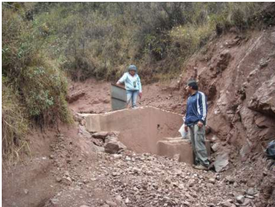
Figura 13: Caja reservorio, recepciona las aguas que descienden de la quebrada Thuniyoq.
