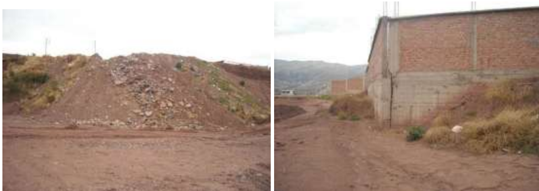
Foto 18: Se observa en el flanco izquierdo arrojado de material de desmonte y en el flanco derecho el muro de contención de una vivienda, estos vienen reduciendo las dimensiones del disipador.
