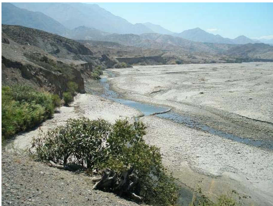
Foto: Erosión fluvial en la margen derecha del río Chicaza, podría afectar carretera. Sector Tierras Negras, distrito de Cascas, provincia Gran Chimú.
