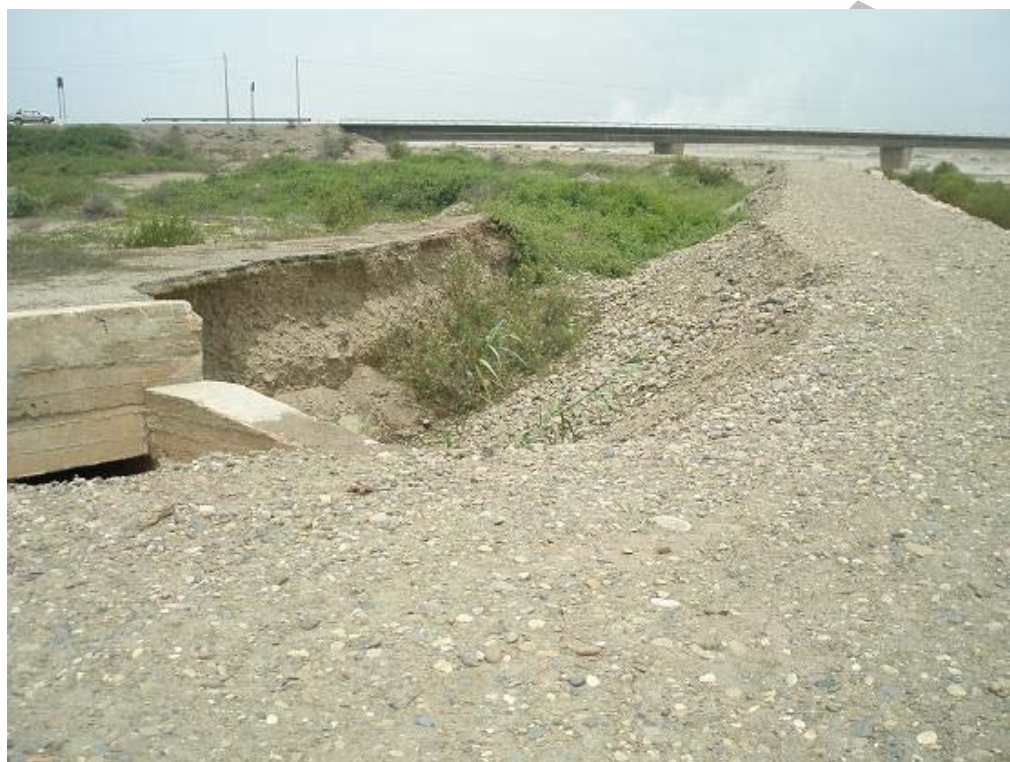
Foto. Área susceptible a inundación fluvial y erosión fluvial. Sector puente Careaga, distrito Chicama, provincia Ascope.
