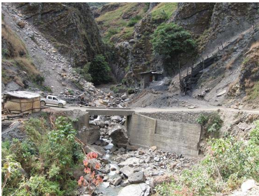
Foto: Derrumbe entre la quebrada Lirios y Ciénegos, distrito Huaranchal, provincia Otuzco, afecta carretera de acceso a Huaranchal.
