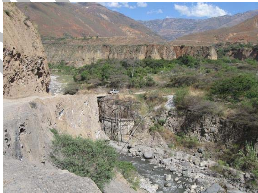
Foto: Erosión fluvial en ambas márgenes de la quebrada Charat, distrito de Huaranchal, provincia Otuzco. Se observa un puente aproximadamente de 20 m de luz abandonado a media construcción.
