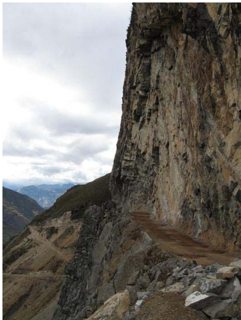
Foto. Talud susceptible a caída de rocas en el cerro Cacañan, distrito Sitabamba, provincia Santiago de Chuco.
