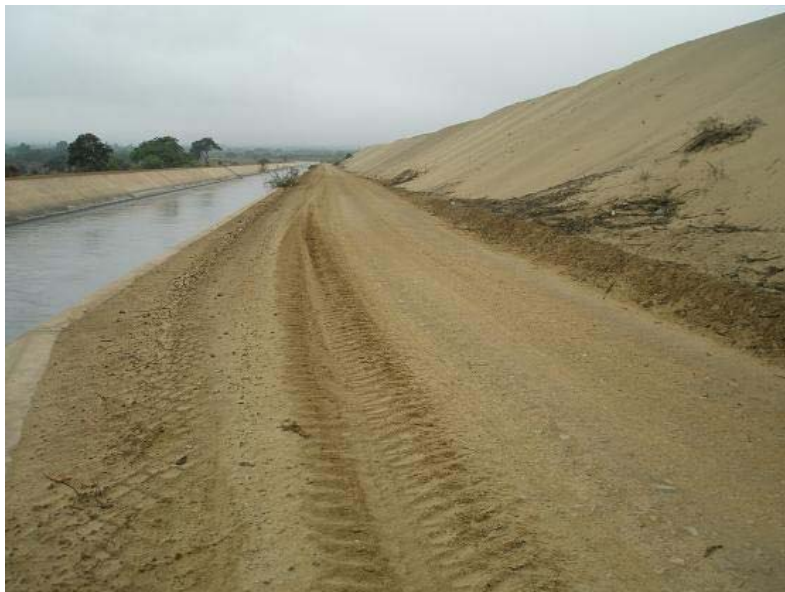
Foto: Arenamiento en el Cerro Urango, afecta canal del proyecto Chavimochic, distrito Chao, provincia Virú.
