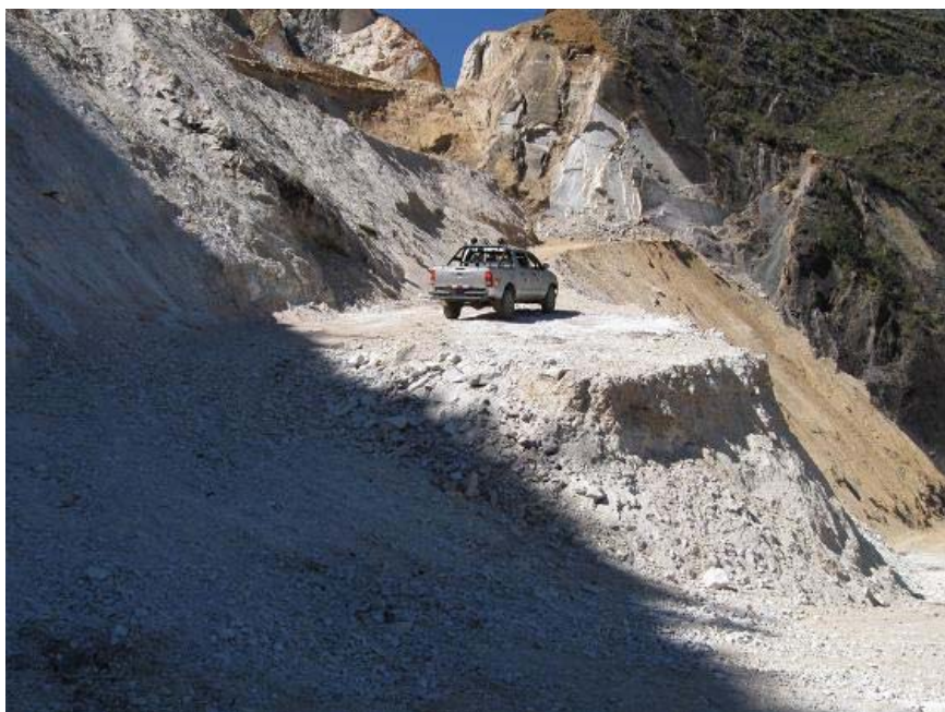
Foto 28. Área susceptible a derrumbe-flujo en la parte alta de Adaumas, distrito de Zanagorán, provincia Sanchez Carrión.
