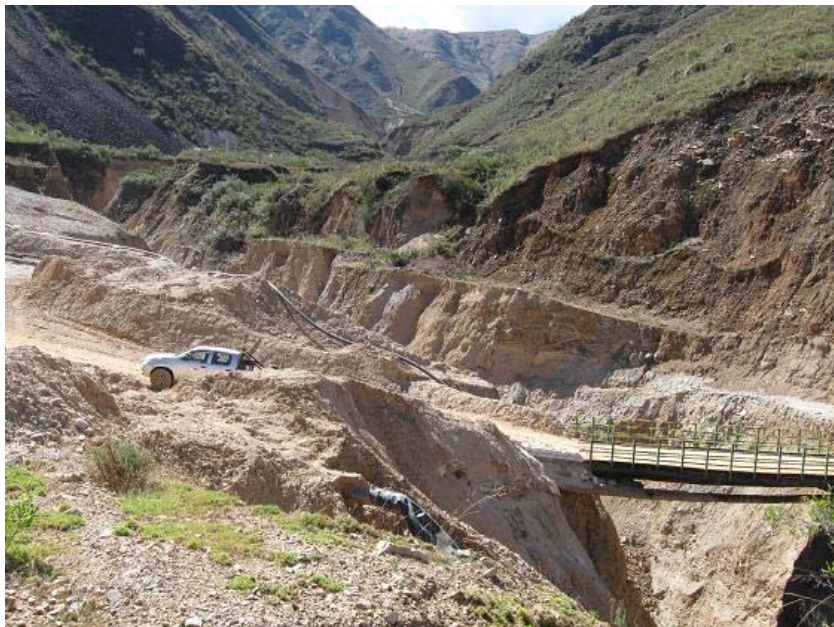
Foto: Erosión de laderas en la quebrada Potrero, distrito Angamarca, provincia Santiago de Chuco. También presenta derrumbes.
