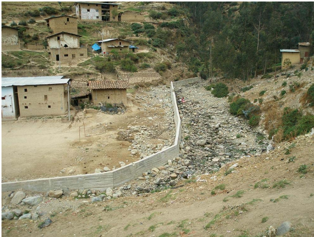
Foto: Erosión fluvial en ambas márgenes del río Santa Lucía sector San Ignacio. Como medida de protección se ha construido un muro invadiendo el cauce de río.
