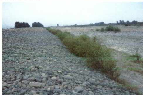
DEFENSAS RIBEREÑAS EXISTENTES / TALUD ESTABLE
