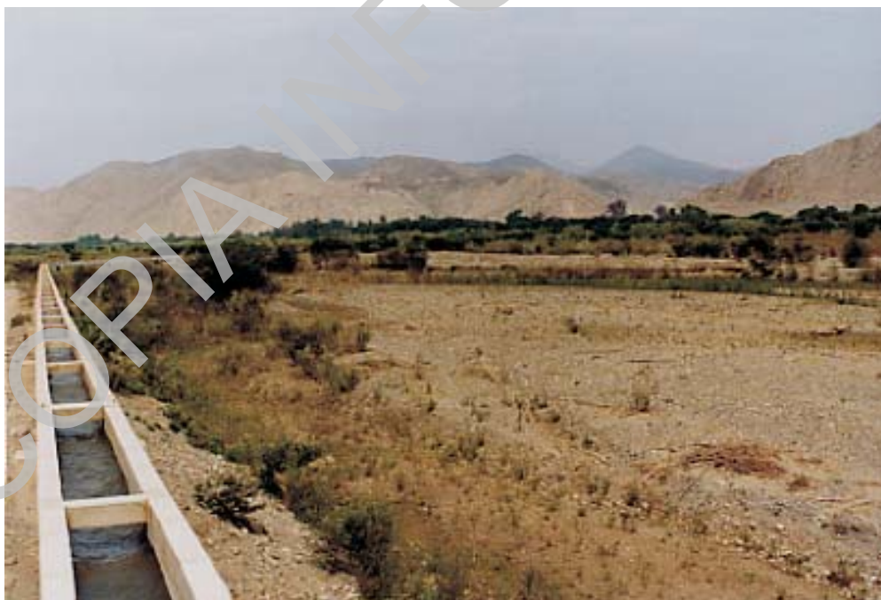
Foto N° 99 Erosión fluvial en la margen derecha del río Huarmey, compromete canal de irrigación y un tramo de la carretera Huarmey-Aija en el km 15+200. (Foto L. Fidel).
