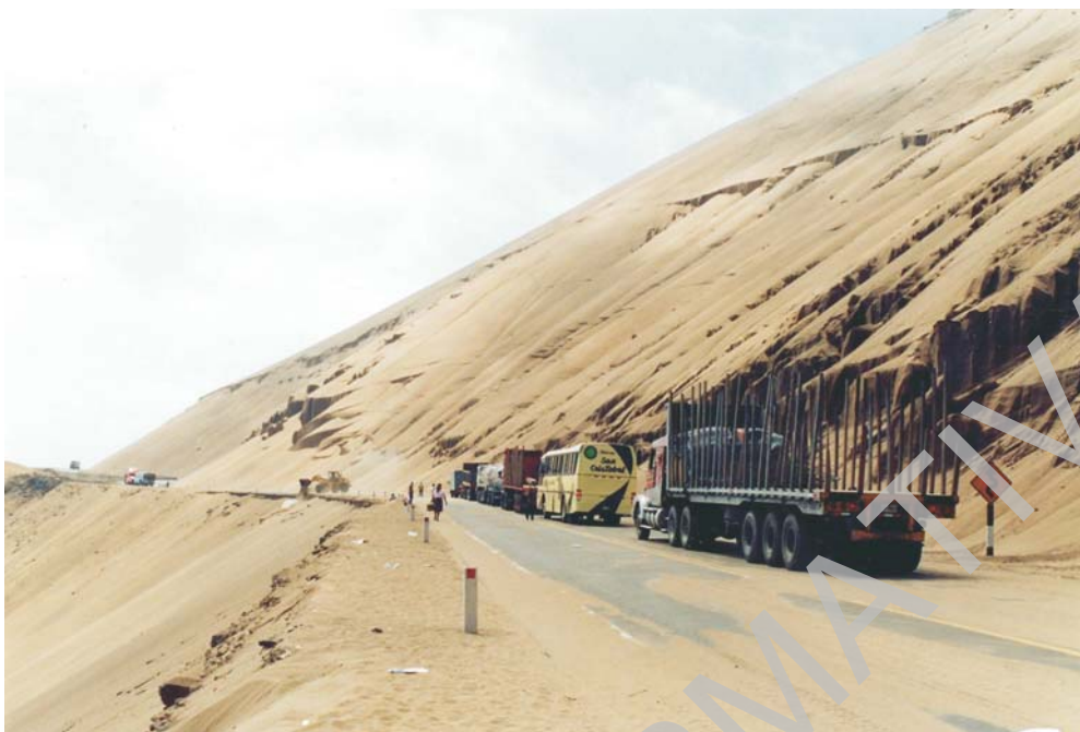
Foto N° 108 Zona Crítica: Sector Pasamayo. Taludes con depósitos eólicos, afectados constantemente por derrumbes, deslizamientos de arena y arenamientos, que afectan tráfico en varios tramos de la Carretera Panamericana Norte. (Foto S. Núñez).
