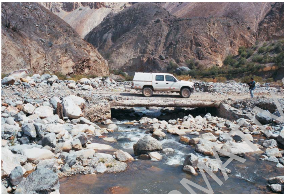
Foto N° 98 Puente Caujul, carretera Churín-Caujul, sobre la quebrada Huancay (cuena del río Huaura), afectada periódicamente por huaycos y erosión fluvial. (Foto L. Fidel).
