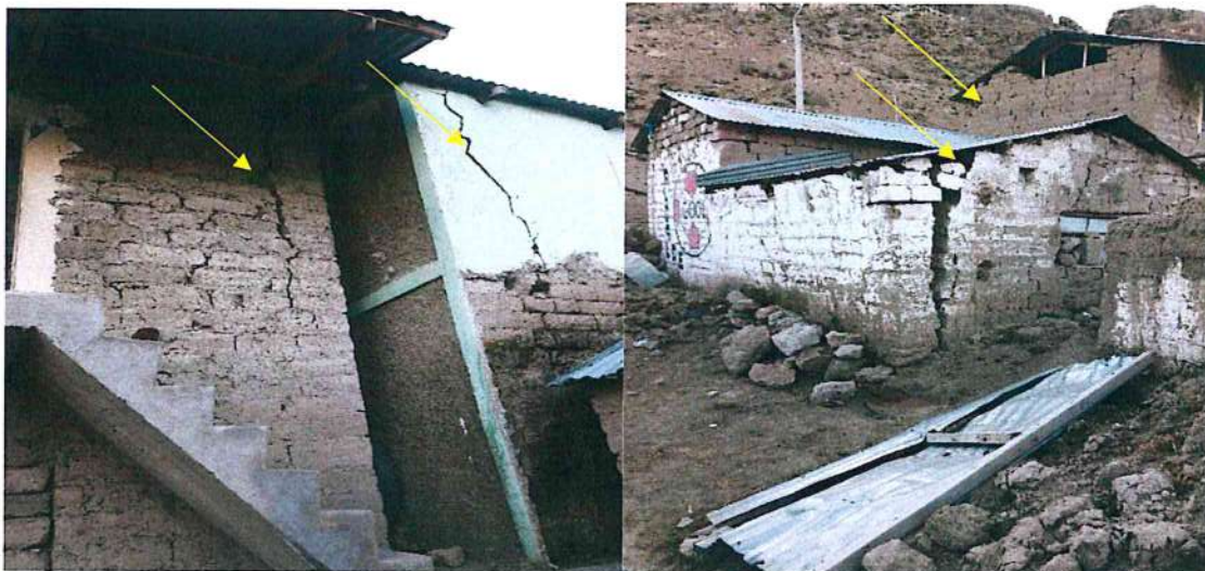
Figura N° 17 Daños en las viviendas, se muestran agrietadas las paredes, techos y pisos, por lo que no pueden ser habitadas.
