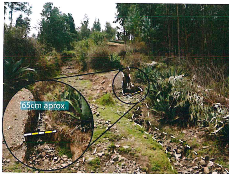
Figura 8. Se observan grietas con separación de 0.40 a 0.65 m, al Este del barrio de Cochac.
