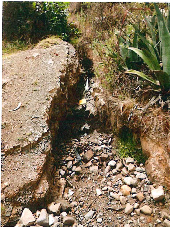
Fotografía 2: Se aprecian arcillitas de la Formación Santa, separadas por una grieta erosionada por aguas de escorrentía pluvial.
