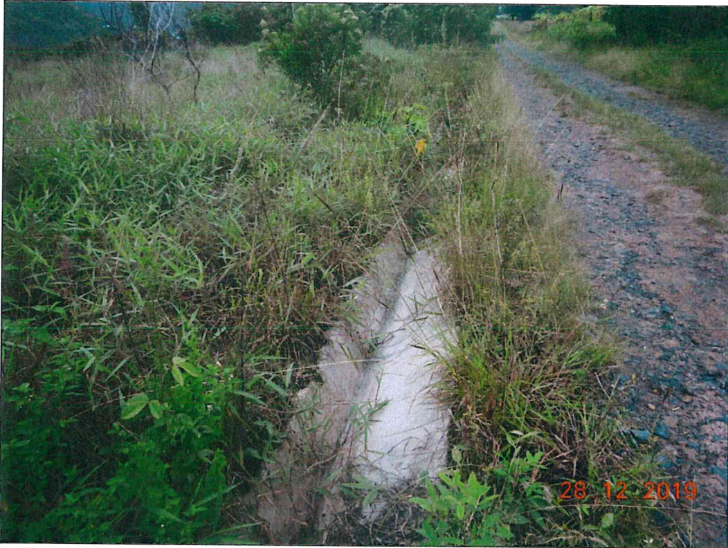
Fotografía 10. Vista de canales de drenaje en ambas márgenes del camino carrozable que conduce al sector El Potrero.
