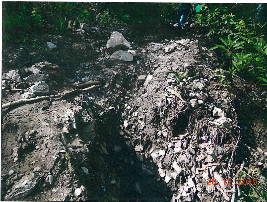
Fotografía 7. Erosión y profundización en la laderas del cerro San Valentín producto de la escorrentía pluvial.
