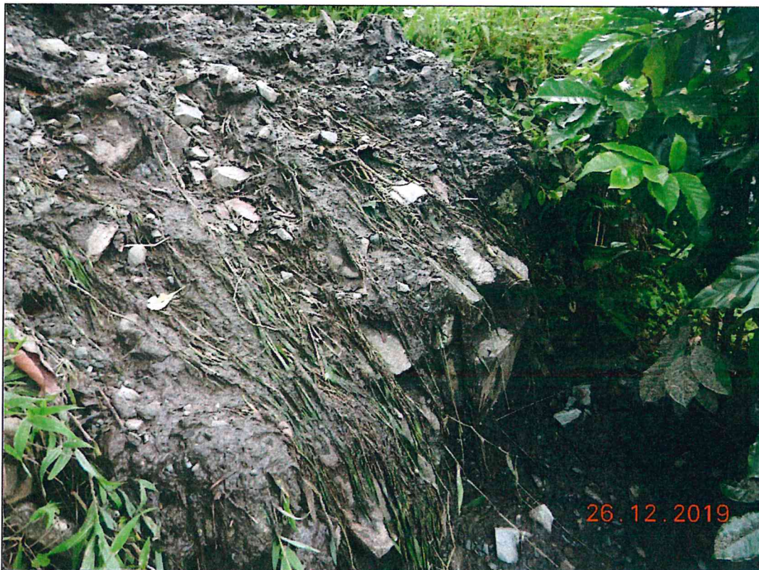
Fotografía 6. Vista de muros secos en la zona media – baja, actúan como retenedores de material acarreado.
