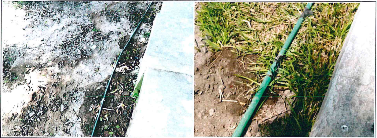
Figura 12: Vista de mangueras en mal estado, con fugas de agua ubicadas en el jardín del malecón Pedro de Osma, ubicado por encima de la zona de derrumbe.
