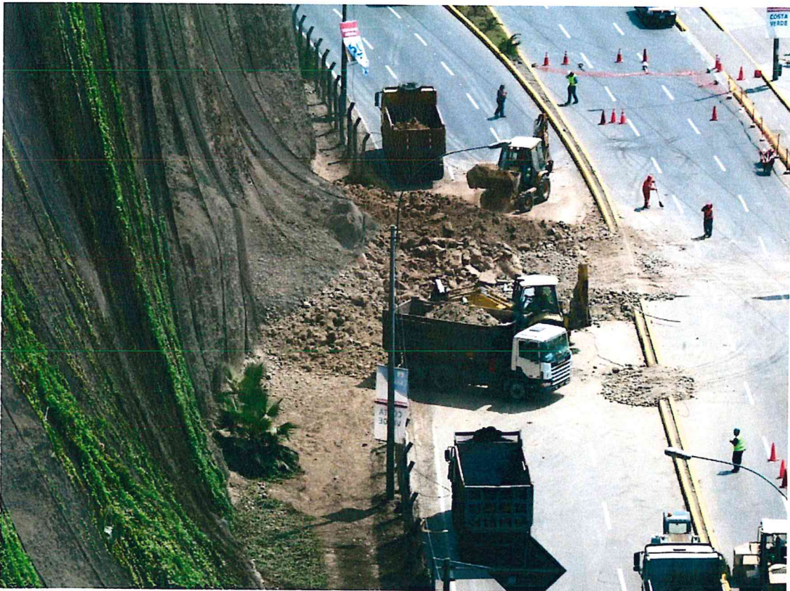
Fotografía 2: Vista con dirección al sur donde se puede observar las labores de limpieza del carril sur a norte bloqueado con el material del derrumbe.
