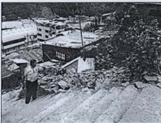
Foto 6.- Antiguo muro de contención que fue destruido por la última caída de rocas (26 de enero del 2006).
