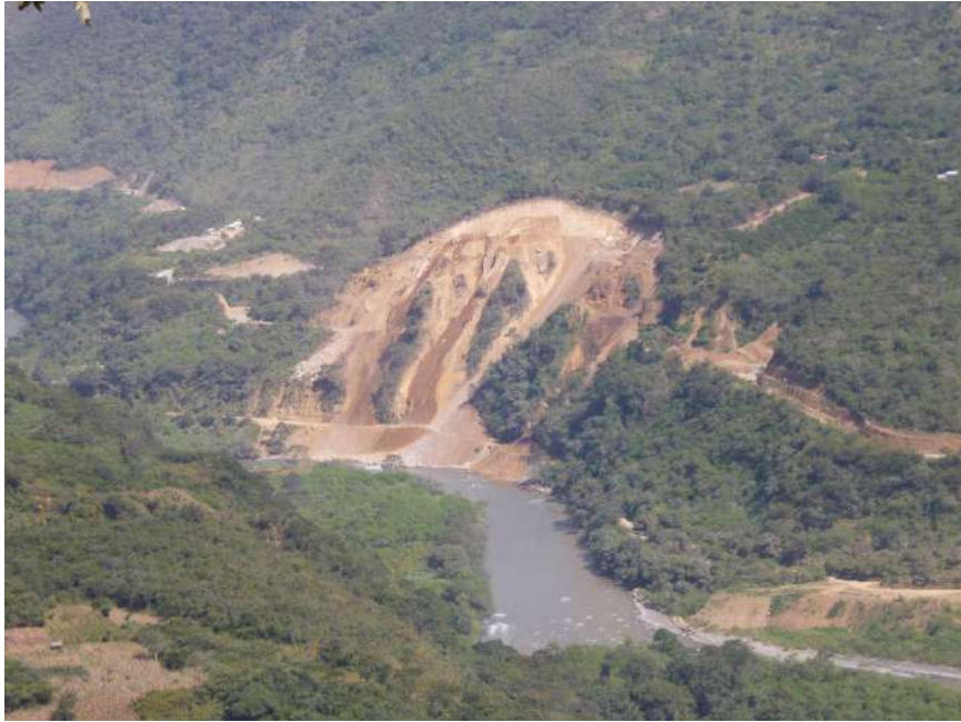
Foto 31: Derrumbe en talud superior de carretera, cortó el tránsito hacia Echarati, se vienen realizando trabajos de banquetado en el talud de corte.
