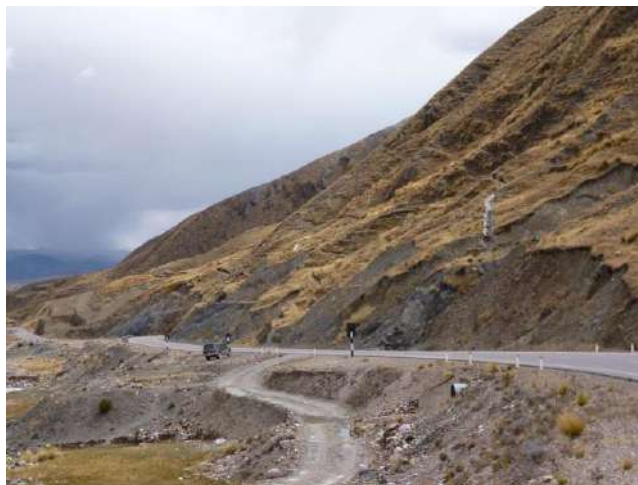
Foto 58: Taludes superiores inestables de la carretera Interoceánica en el sector de Cotaña, se han colocado cunetas de coronación en la zona.
