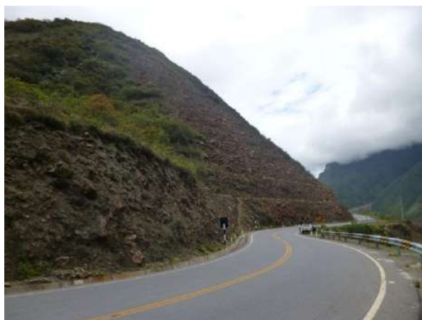
Foto 47: Km 143+500 de la carretera Interoceánica, altura del talud de corte de hasta 250 m, se han cortado varia banquetas para estabilizar la zona; hay caída de cantos de roca.
