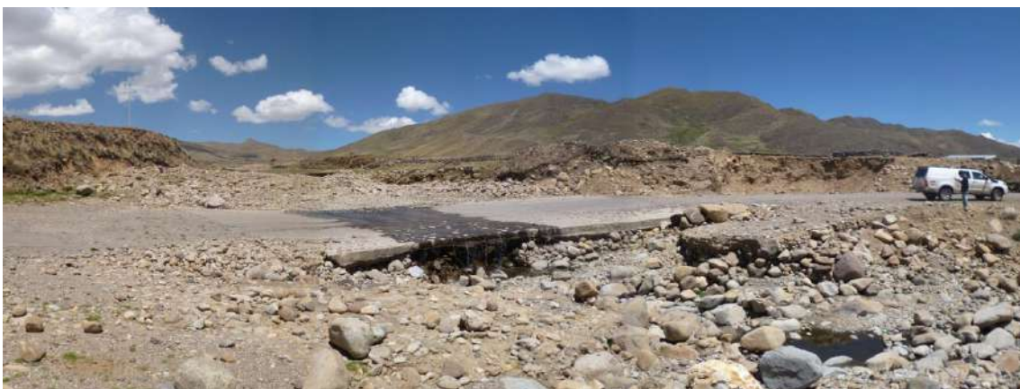
Foto 3: Quebrada Ccanco Ccala corta la carretera a Velille, en la foto se puede observar la socavación que bien produciendo actualmente en el badén.
