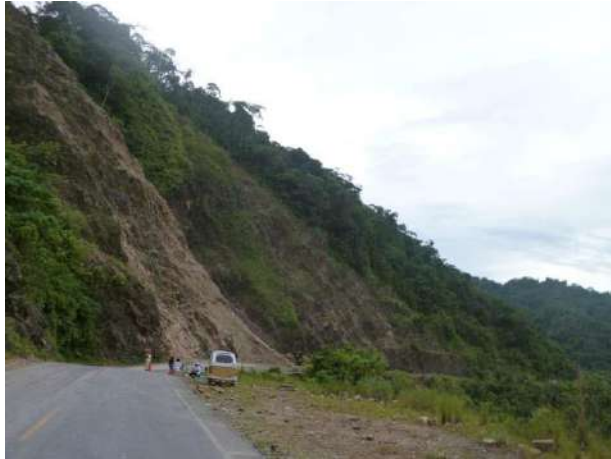
Foto 50: Derrumbe en talud superior de carretera cerca del sector de Villanuvia, material caído bloqueo el paso por varios días.
