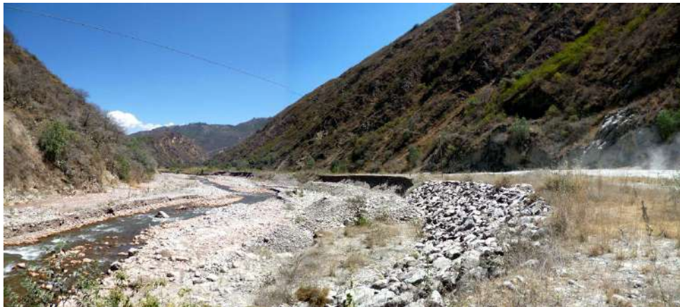
Foto 74: Erosión fluvial en la margen derecha del río Colorado, afectó la carretera Abancay-Cusco.
