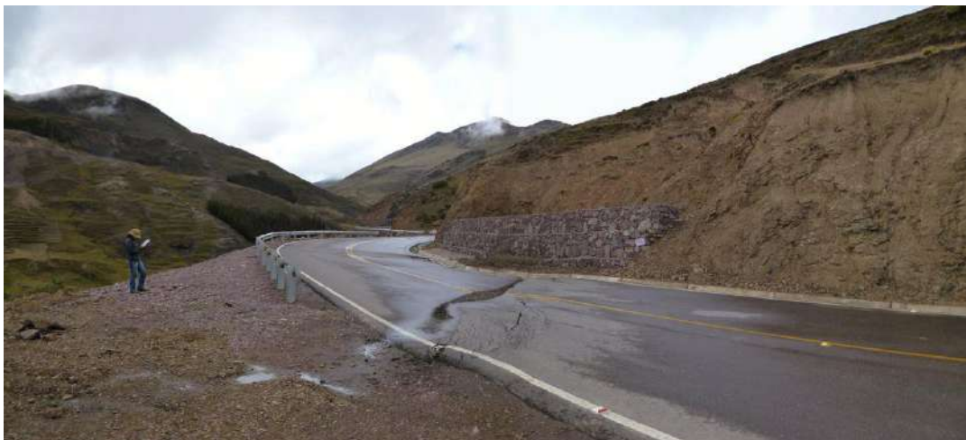
Foto 36: Asentamiento en plataforma de carretera en el km 14+560 de la carretera Calca-Yanatile, sustrato de filitas y pizarras.
