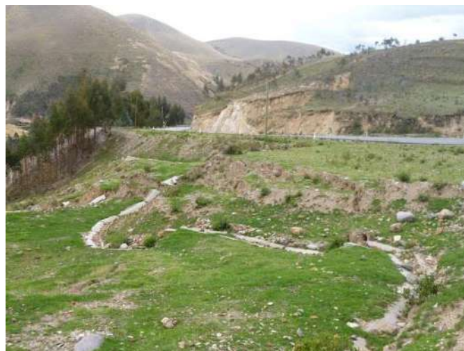
Foto 61: Deslizamiento en talud inferior de la carretera Interoceánica, sector de Jillicunca, cuneta se encuentra rota y desplazada.
