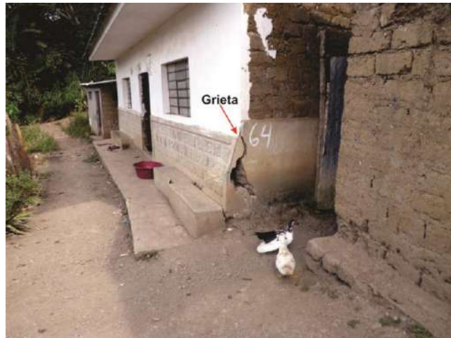
Foto 12: Vivienda agrietada en el sector de Cochapampa.
