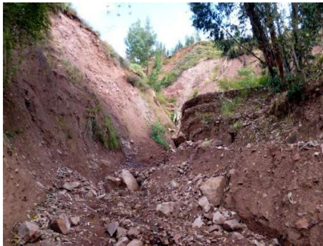
Foto 39: Sector de Coya, ladera del cerro Bandera cortada por quebrada con derrumbes activos en su cabecera, materiales sueltos son acarreados en forma de huaicos. Se puede observar los muros de gaviones destruidos.
