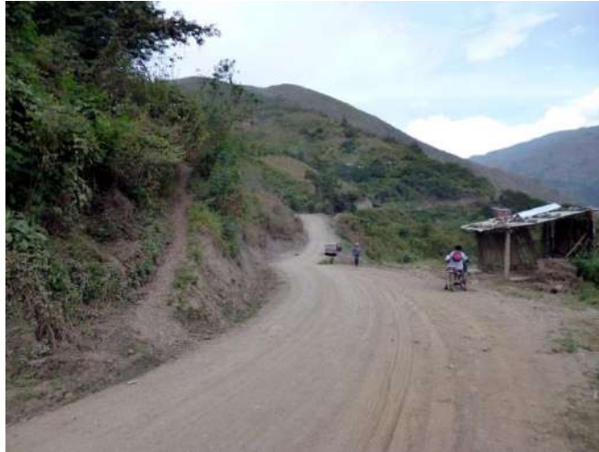
Foto 24: Asentamiento de casi un metro en la plataforma de carretera que lleva a Yanatile.
