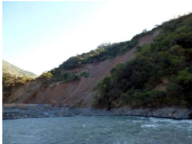
Foto 19: Deslizamiento en el sector de Naranjal, produce asentamientos en plataforma de carretera que conduce a Vilcabamba y al poblado de Socospata; el río Vilcabamba produce erosión en el pie del deslizamiento. Se construye muro de concreto para controlar la erosión.
