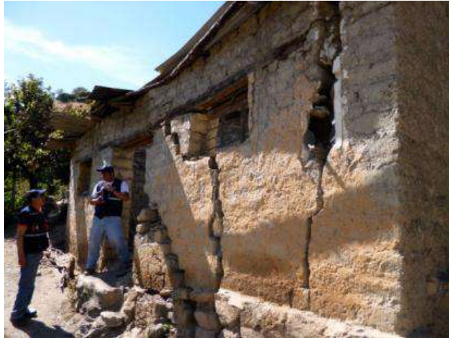
Foto 18: Vivienda agrietada en el sector de Sullucuyoc.
