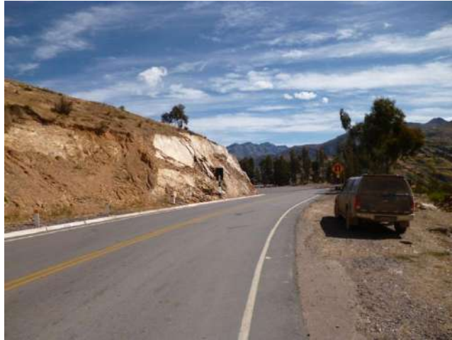
Foto 100. Talud superior de carretera conformado de filitas y pizarras, bloques caen por falla planar.
