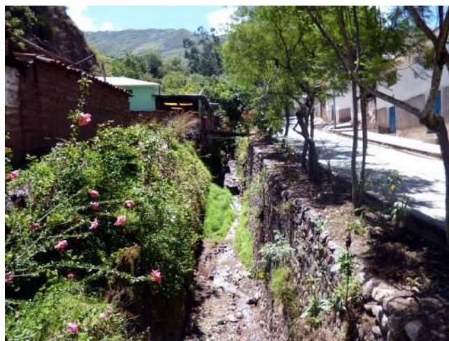
Foto 75: Torrentera sin nombre que pasa por el poblado de Limatambo, encausada con muros de roca.
