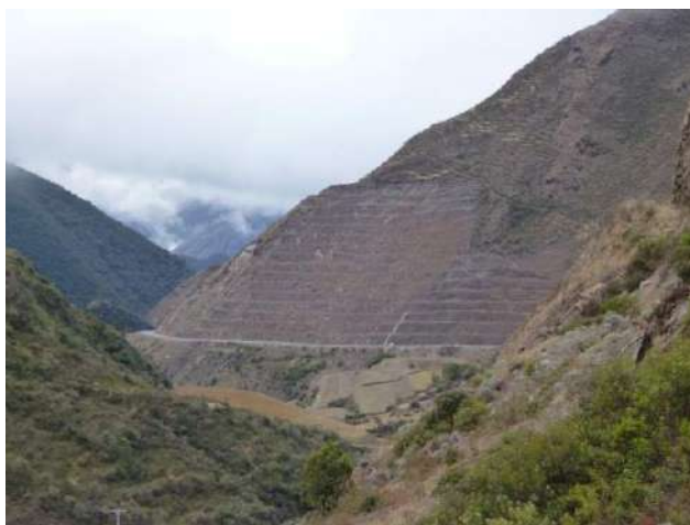
Foto 53: Derrumbe en talud superior de carretera en el km 115+950 de la carretera Interoceánica, se ha tenido que hacer banquetas en el talud para estabilizar la zona.
