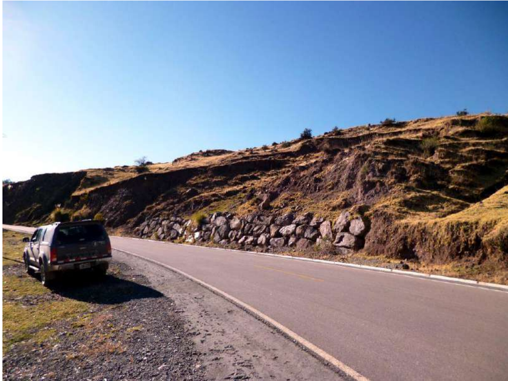
Foto 110: Carretera Acomayo-Pitumarca, zona donde se presenta asentamiento en el talud superior de carretera por efectos de un deslizamiento activo.
