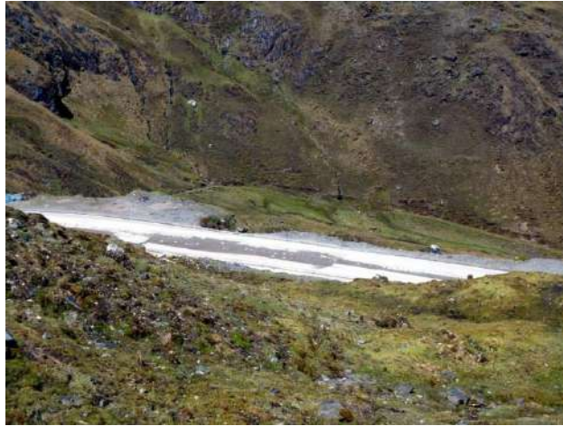
Foto 7: Asentamiento en plataforma de carretera, cerca del abra Málaga.
