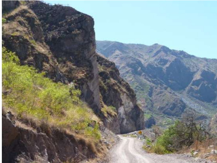
Foto 108: Talud de corte vertical de casi 40 m de altura, muy inestable, desde donde se produce la caída de bloques de roca y suelo.
