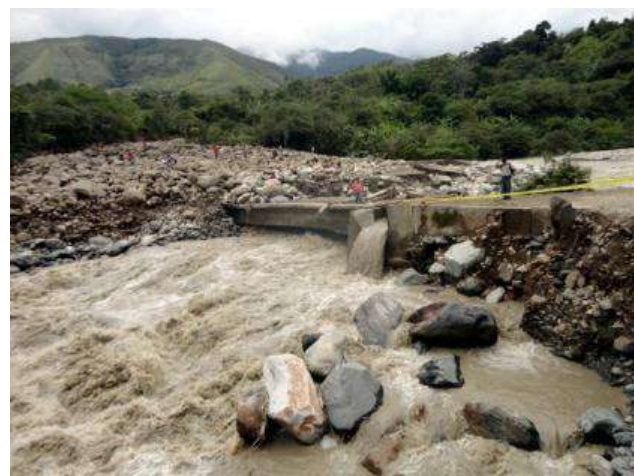
Foto 11: Puente que cruza el río Lúcumá cubierto por el flujo de detritos de la quebrada Calquiña en Huyro.
