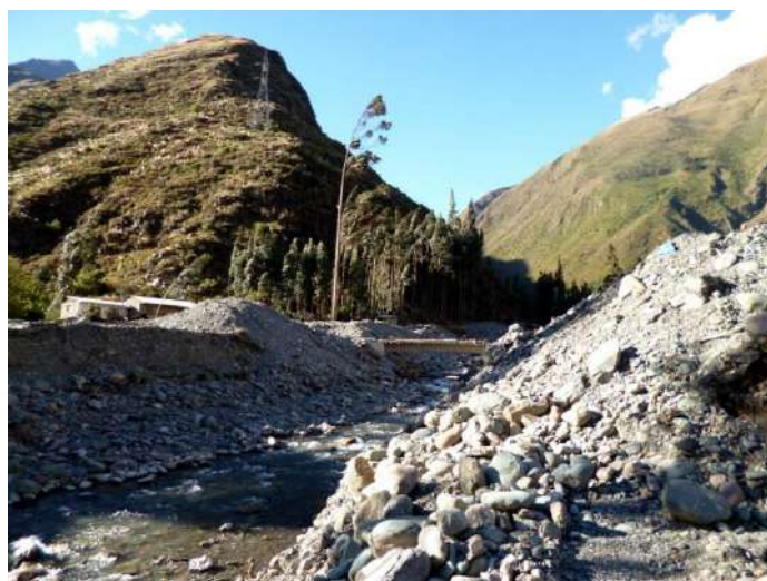
Foto 85: Quebrada Tanjac, material que acarrió el huaico del 9 de febrero del 2013, sobrepaso la capacidad de carga del cauce, produciendo reboses que formaron albardones, vivienda del Pirhi y Tanjac fueron destruidas con este huaico.
