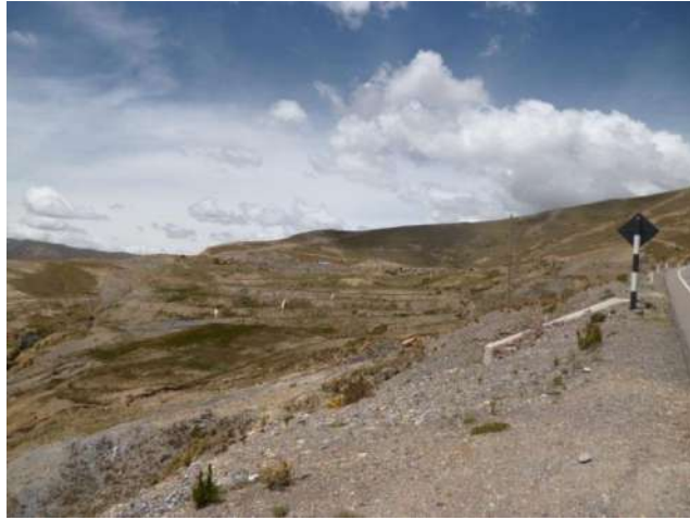
Foto 65: Deslizamiento que produce asentamientos en plataforma de carretera Interoceánica en el cerro Josjohuarina.
