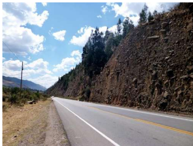
Foto 70: Talud superior de carretera subvertical entre el km 1048+800 al km 1049+100, se producen derrumbes y caídas de clastos.
