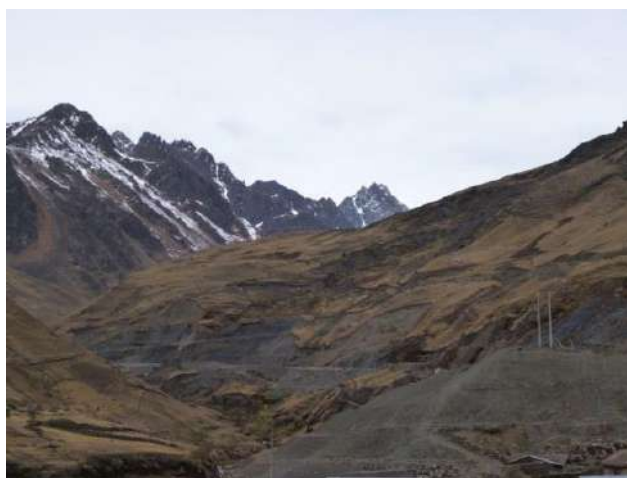
Foto 55: Derrumbes y deslizamientos en talud superior e inferior de carretera, compromete secuencia de pizarras negras, produce pérdida de plataforma de carretera, km 104+900 de la Interoceánica.
