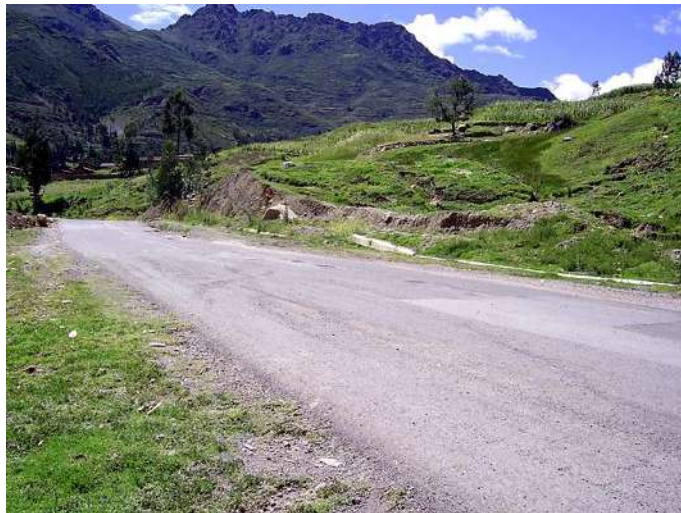
Foto 42: Asentamientos y perdida de plataforma entre el km 4+100 al km 4+900 de carretera de acceso a Pisac y Paucartambo.
