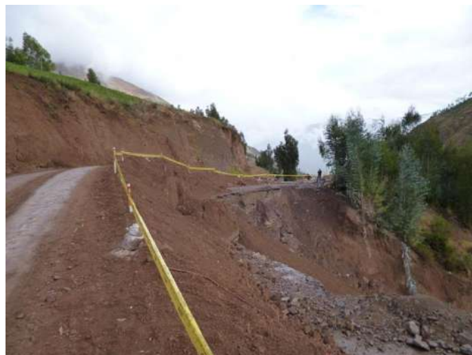
Foto 37: Deslizamiento que corto toda la plataforma de carretera en el km 3+630 de la carretera Calca-Yanatile, sustrato de areniscas, limolitas roja e ignimbritas.
