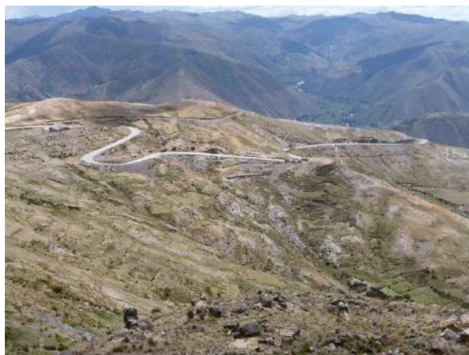
Foto 67: Asentamiento de plataforma de carretera Interoceánica en el km 10+380, se están realizando trabajos de estabilización.
