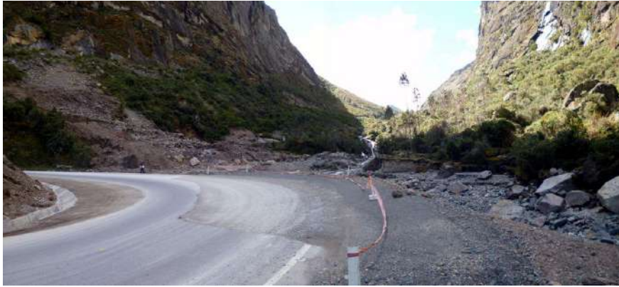
Foto 83: Efectos del huaico de la quebrada Tanjac, erosionó varios tramos de la carretera que conduce a Quillabamba.
