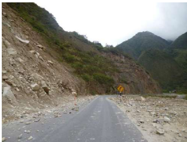
Foto 49: Detritos caídos obstaculizan el tránsito por la carretera Interoceánica en el km 148+500.
