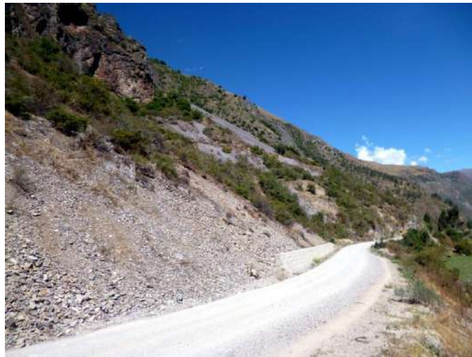
Foto 90: Derrumbes en talud superior de la carretera Ollantaytambo-Ocobamba, compromete conos de talus.
