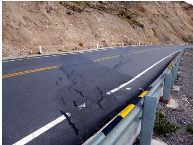
Foto 66: Plataforma de carretera asfaltada agrietada y con asentamientos.
