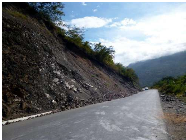
Foto 26: Derrumbes en el talud superior de la carretera km136+900, material caído obstruye la cuneta.
