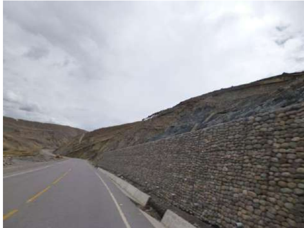
Foto 56: Talud superior de carretera sostenido con muro de gaviones en el cerro Pucaloma; substrato comprometido es de pizarras y lutitas.
