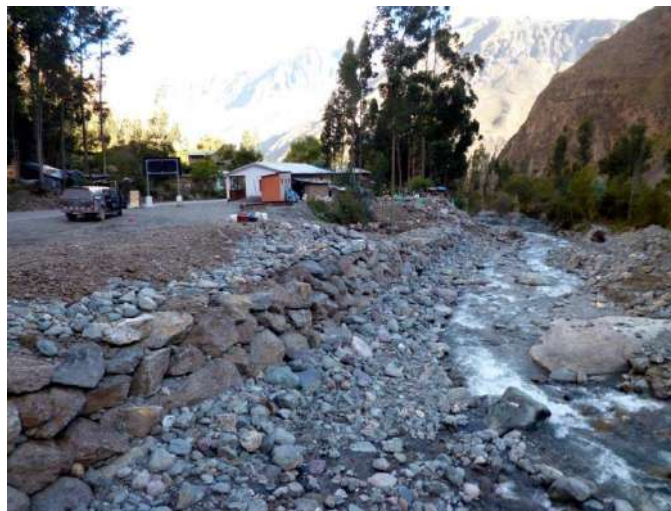
Foto 84: Erosión de las margenes de la quebrada Tanjac en el sector de Phiri, pudo afectar viviendas y tramo de carretera.
