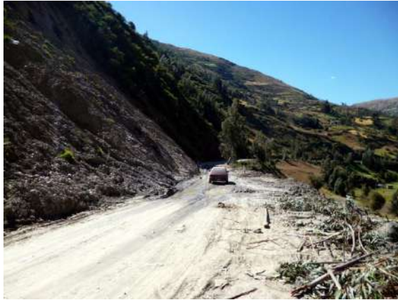
Foto 94: Derrumbe-flujo de detritos en el talud superior de carretera que conduce de Paucartambo a Challabamba.
