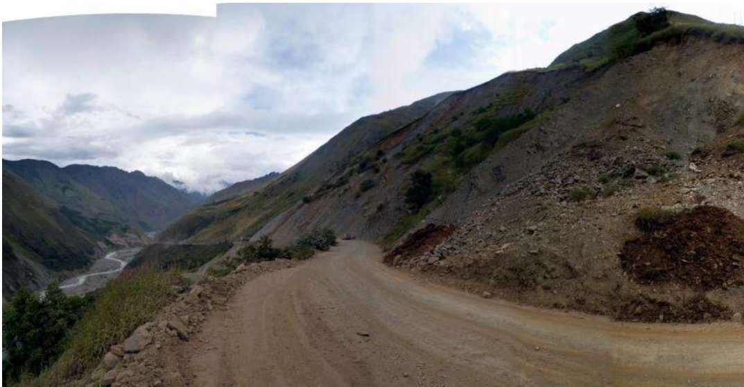
Foto 14: Derrumbe activo de Cocalmayo, produce la obstrucción de la carretera, también hay asentamientos en la plataforma de carretera.
