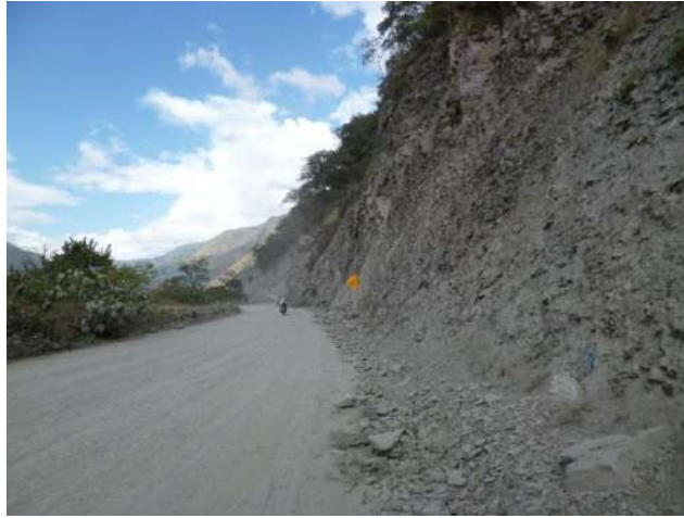
Foto 27: Km 130+900 de la carretera a Santa Ana-Quillabamba, tramo sin asfaltar, material caído del talud superior se acumula al pie y obstruye la carretera.
