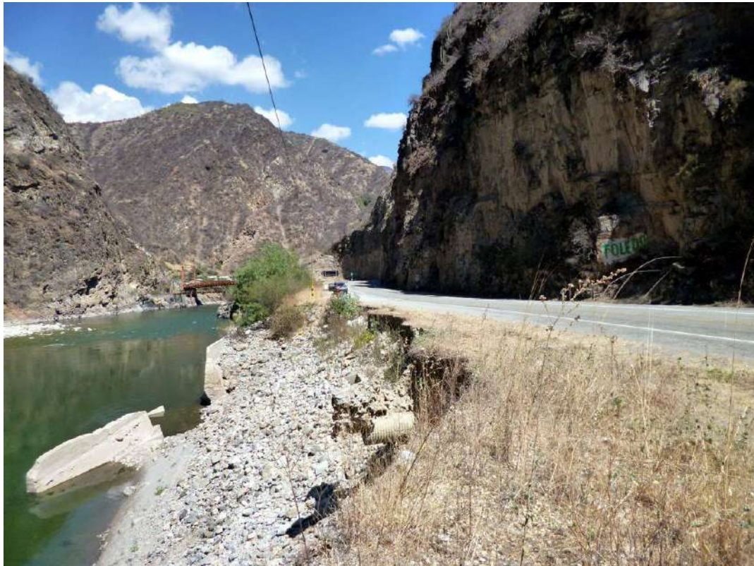
Foto 77: Erosión aguas en el talud inferior de carretera, margen derecha del río Apurímac, cerca al puente Cunyac.
