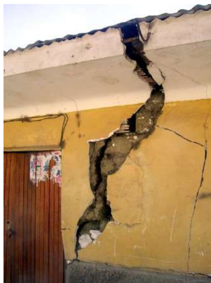
Foto 43: Agrietamientos en paredes de las viviendas en la comunidad de Cuyo Chico.
