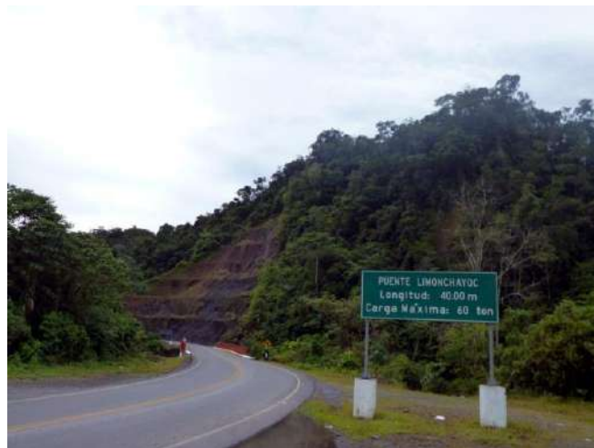
Foto 52: Derrumbes en talud superior de carretera, sector de puente Limonchayoc, se ha cortado banquetas en el talud para estabilizarlo.
