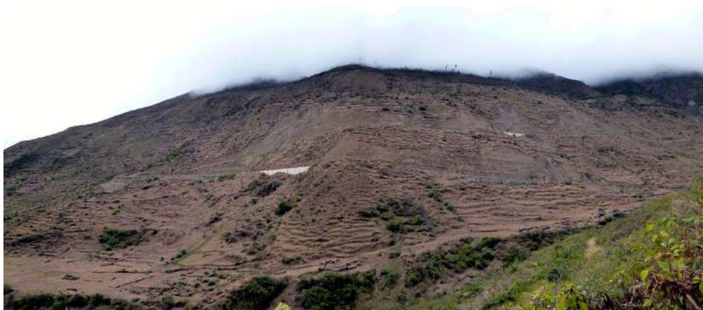
Foto 48: Dos desarrollos de la carretera Interoceánica cerca de la localidad de Marcapata, se presentan taludes inestables por trabajos de ampliación de carretera.
