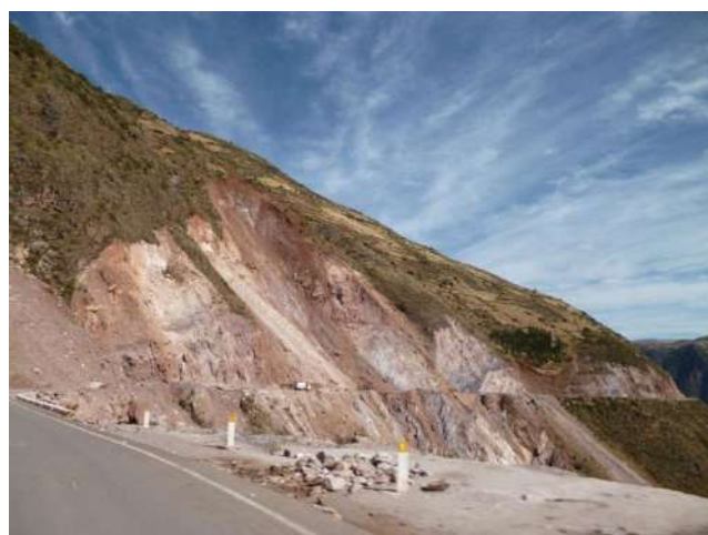
Foto 102: Taludes de más de 40 m de altura en la vía a Huancarani, material caído obstruye la vía.
