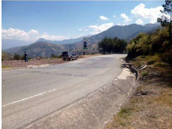
Foto 73: Asentamiento de plataforma y pérdida de asfalto en el km 898 de la vía Abancay-Cusco.
