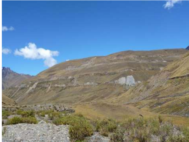
Foto 80: Desarrollo hacia el Abra Malaga, presenta problemas de derrumbes y deslizamientos en sus taludes superiores por obras de ampliación de la plataforma.
