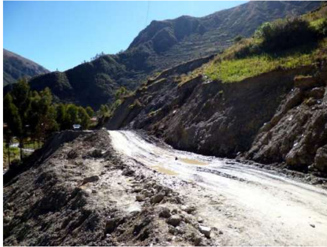
Foto 89. Asentamientos en la carretera producidos por reactivación de deslizamiento flujo en el sector de Huyloc.
