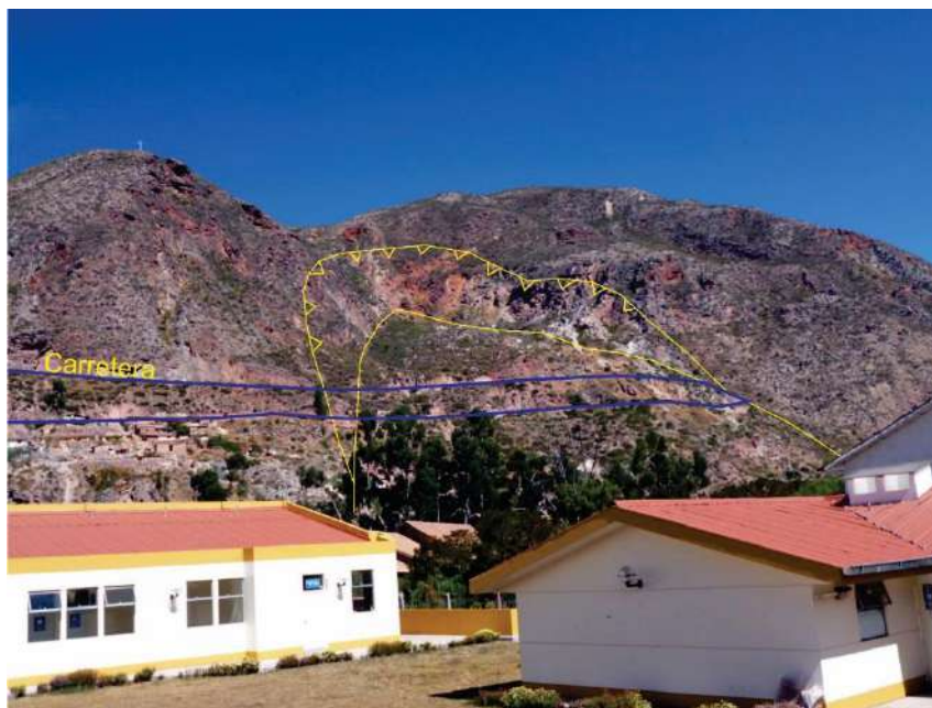
Foto 93: Deslizamiento que produce el asentamiento de la carretera que permite el acceso a Urubamba.
