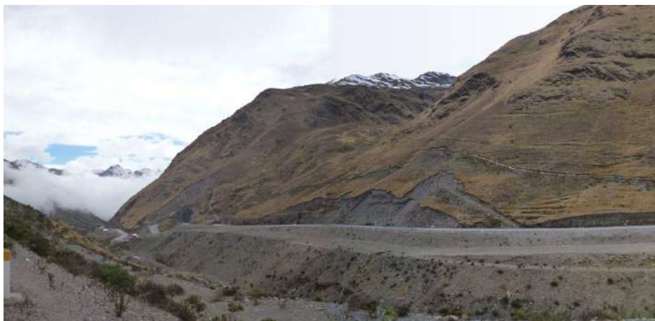
Foto 54: Talud superior inestable por trabajos de ampliación de carretera interoceánica, compromete substrato de pizarras, filitas y depósitos coluviales, a la altura del km 109+900.
