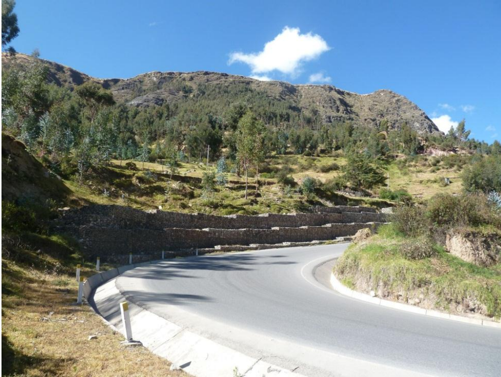
Foto 11: Deslizamiento en el sector de La Florida, se han colocado gaviones en la carretera para contener los asentamiento de la ladera, estos son insuficientes porque el deslizamiento es de gran magnitud.
