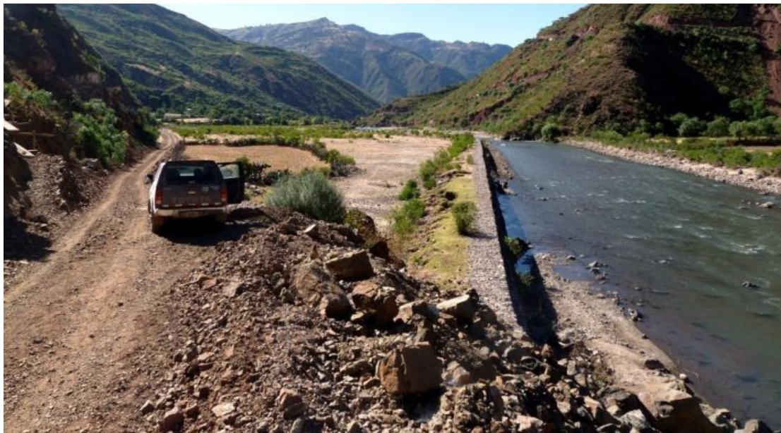
Foto 59: Muros de gaviones para encausar el río Cachi y controlar la erosión en el poblado de Antaparco.
