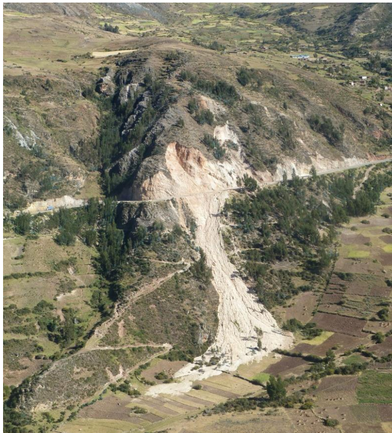
Foto 10: Derrumbe que cortó la plataforma de carretera entre Cachi y Puente Palca (Febrero 2010).
