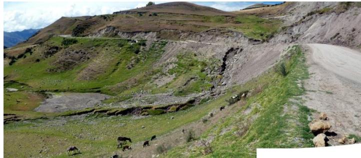
Foto 45: Deslizamiento en el sector de Vista Alegre, produce asentamientos en la carretera Churcampa-Colcabamba.
