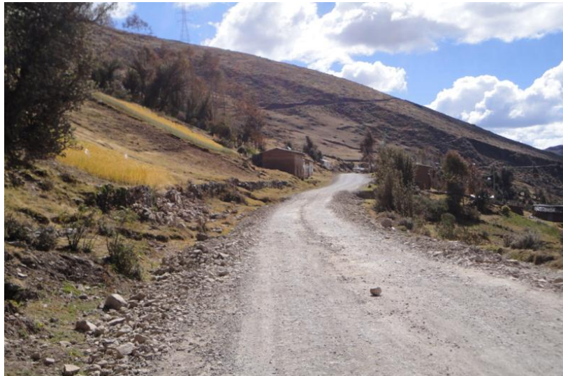
Foto 47: Vista de perfil de los asentamientos y agrietamientos en la plataforma de carretera por efectos de un deslizamiento en el sector de Huaribambilla.
