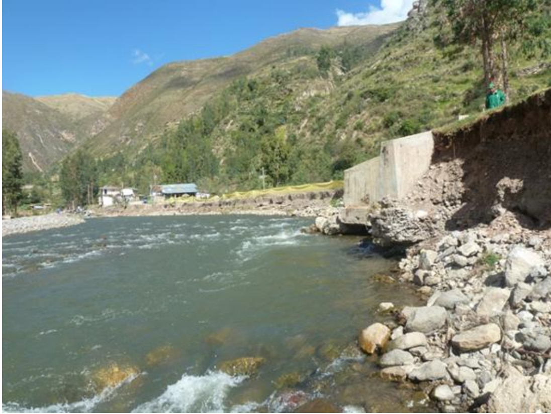
Foto 56: Vista de las bases socavadas de los estribos del puente Alambrioj y erosión en plataforma de carretera.
