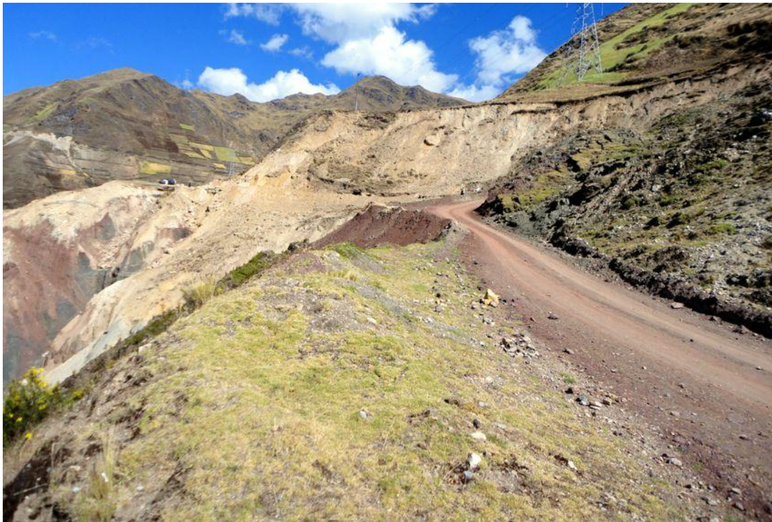
Foto 40: Tramo de carretera Pampas-Ocoro, afectado por deslizamientos producidos por avance retrogresivo de cárcavas.
