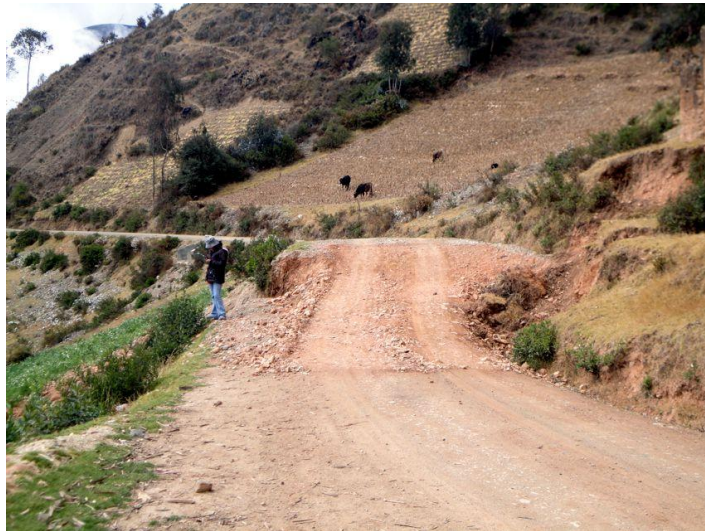
Foto 34: Asentamientos del orden de dos metros en la carretera, sector Santa Cruz de Bellavista.
