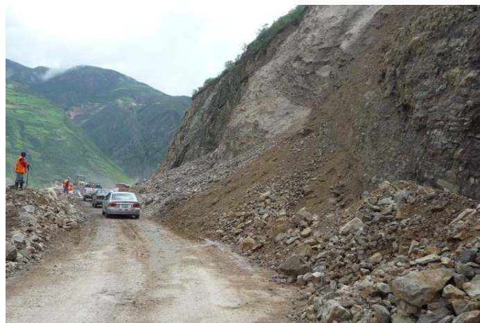
Foto 15: Derrumbes en talud superior de carretera que une Huancayo y Huancavelica por lluvias producidas el mes de febrero del 2010, sector Sonobamba y Chojoma.
