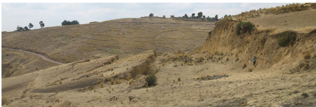
Foto 18: Deslizamiento que afecta el km 5+800 de la carretera Huancavelica-Huaylacuho, salto principal de 6 m, formación de un graven y basculamiento de la ladera.
