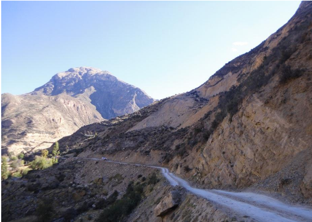
Foto 4: Vista de perfil de la escarpa y cuerpo del derrumbe en el tramo de carretera Manta-Moya, Sector San Carlos- Vilca.
