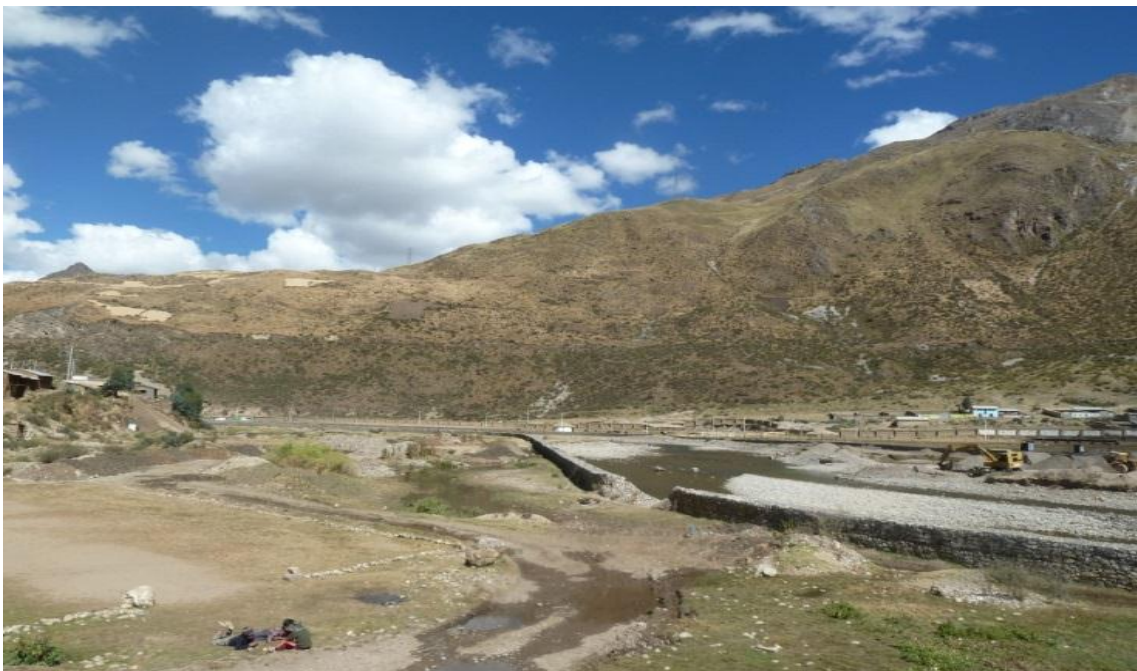
Foto 8: Erosión fluvial en margen izquierdo de Rio Ichu, al ingreso de Huancavelica.
