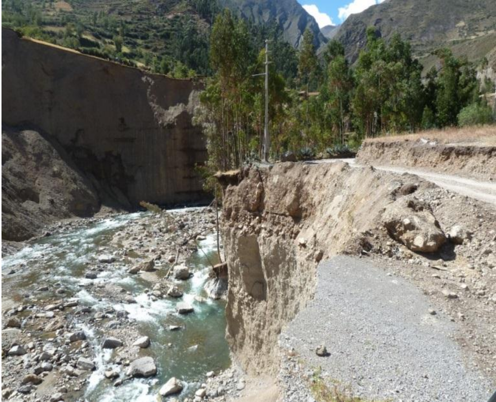
Foto 5: Erosión Fluvial, derrumbes-flujos Sector Acoria-Marsical Cáceres.
