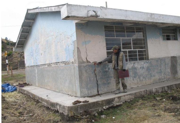
Foto 21: Agrietamientos en paredes y deformación en el marco de la puerta del centro de salud de Antacocha.
