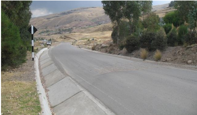
Foto 22: Asentamientos y desplazamientos en plataforma de carretera asfaltada.
