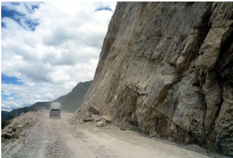
Foto 28: Derrumbe en talud subvertical de calizas, obstruyo tramo de carretera hacia Izcuchaca (Febrero del 2010).
