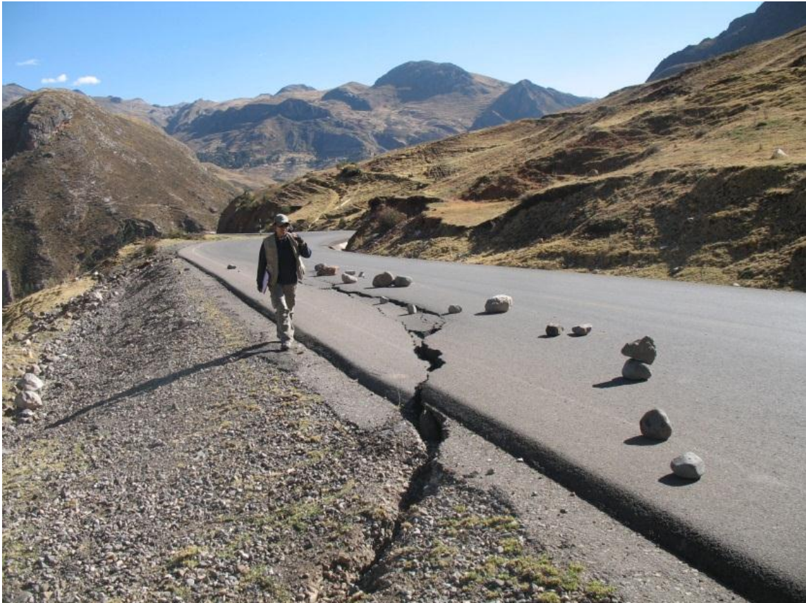
Foto 25: Deslizamiento-flujo de tierra afecta plataforma de carretera en el km 69+980.
