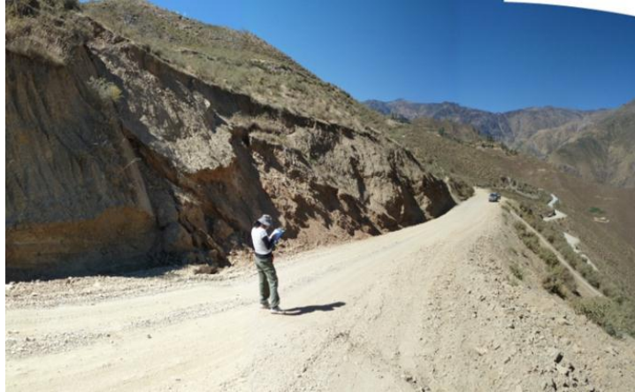
Foto 49: Primeras evidencias del deslizamiento en carretera, manifestado como asentamientos en la plataforma de carretera.
