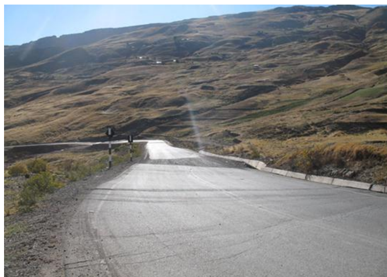
Foto 24: Movimiento complejo de Tontococha, se puede observar los asentamientos, agrietamientos y desplazamiento de la plataforma de carretera.
