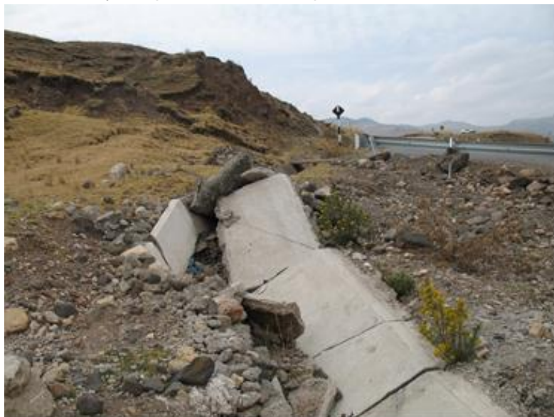
Foto 23: Grieta de corte del deslizamiento-flujo de tierra, daños causados en la cuneta.
