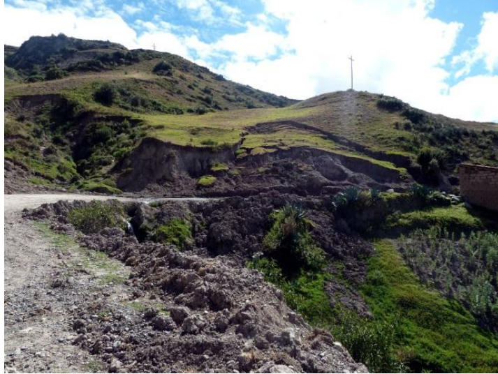
Foto 44: Deslizamiento en talud superior de carretera, localizado encima del poblado de Churcampa.
