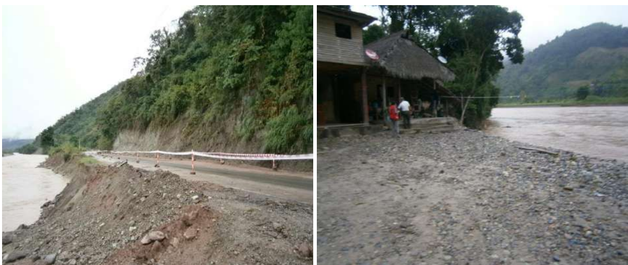
Foto 7.9. Erosión fluvial en la margen derecha del río Perené, afecta tramo de la Carretera Marginal, sector Shintoriato (izquierda). A la derecha se observa el sector Bajo Quivinaqui ubicado en la margen derecha del río Perené en confluencia con el río Ubiriqui afectado por el desborde del río.
