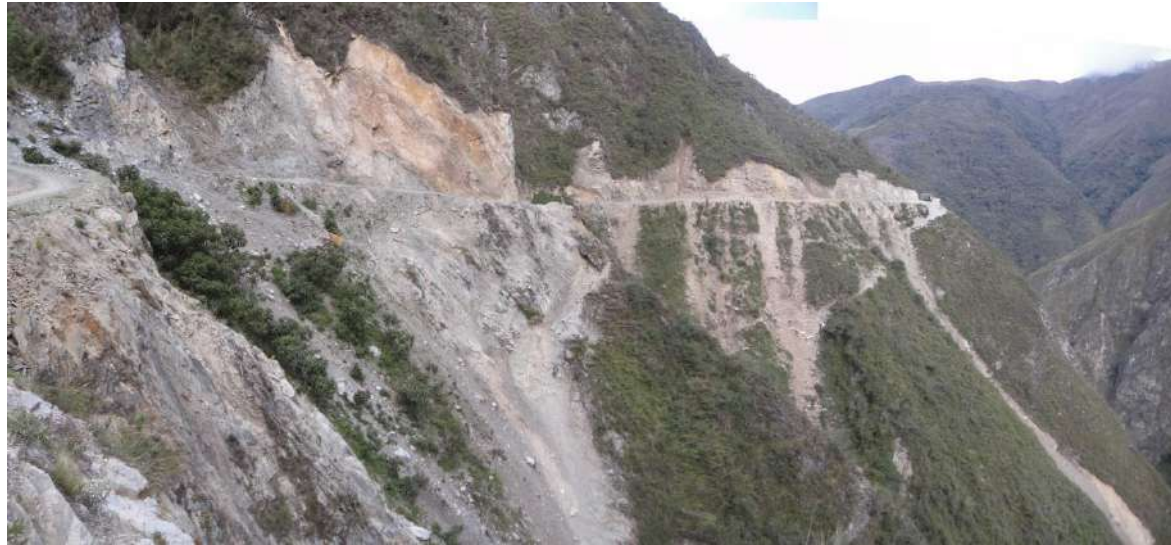
Foto 7.4. Derrumbes en el talud superior de la carretera Anturqui – Huanchiro (San Pedro de Cajas, Tarma).
