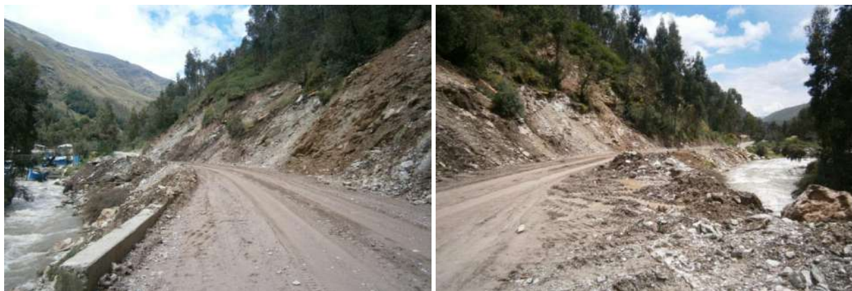
Foto 7.29. Derrumbes en el talud superior de la carretera a Huancayo, tramo km 4+800 al km 7+100 de la carretera, ambas márgenes del río Shullcas.
