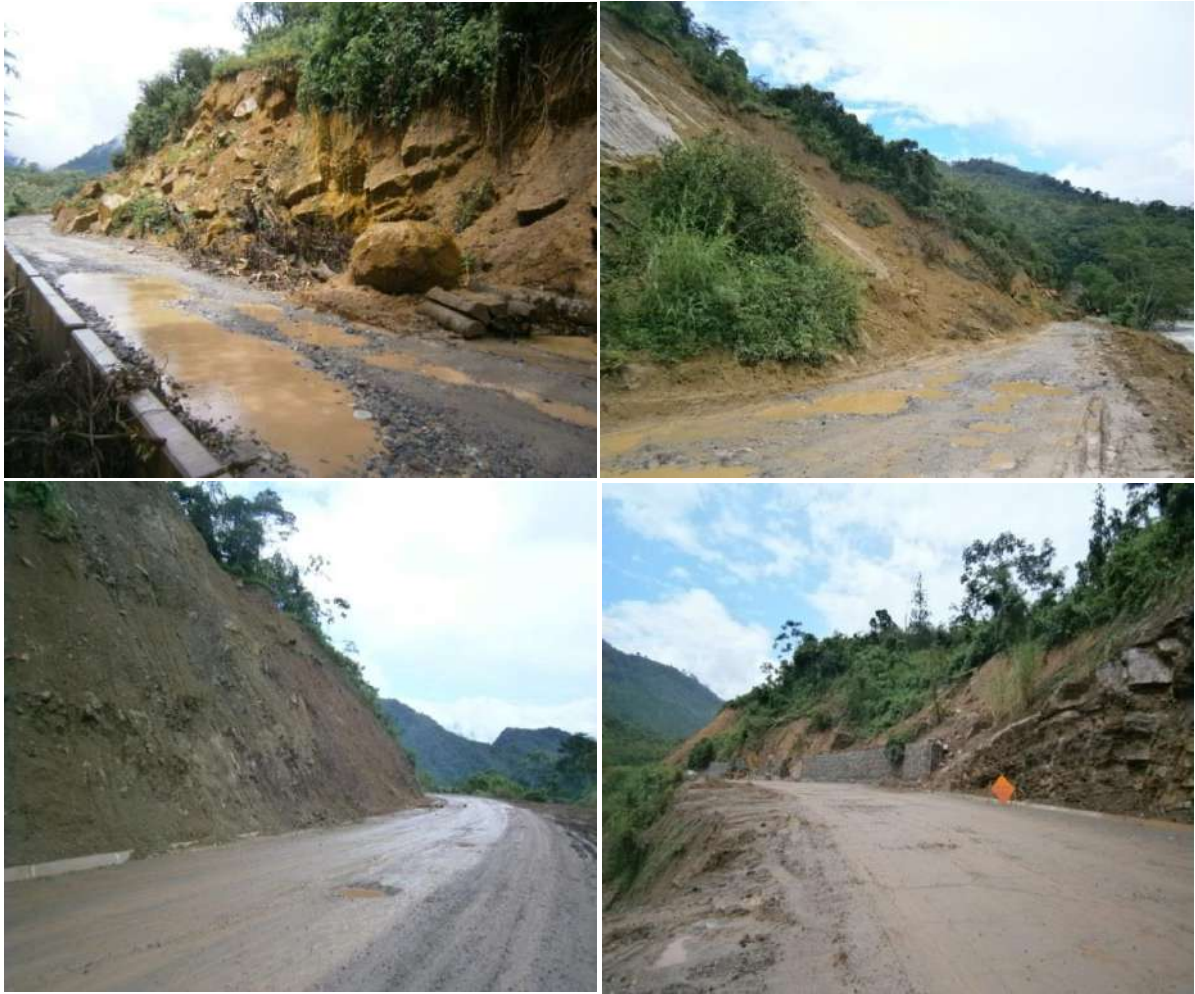
Foto 7.8. Vista de diferentes tramos de la carretera La Merced – Paucartambo, sector Puente Capelo donde se observa el suelo saturado que genera flujos y derrumbes, obstaculizando el tránsito.
