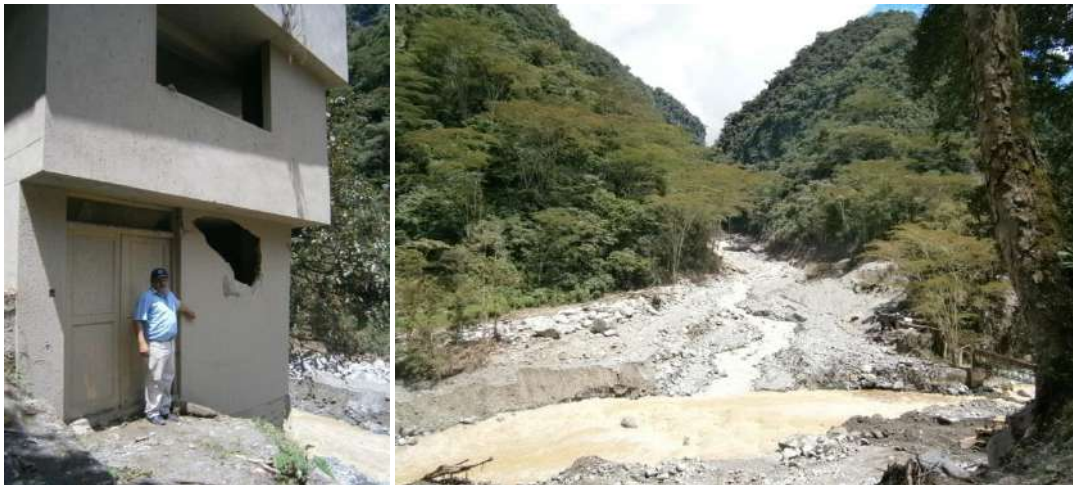
Foto 7.13. Vista de los daños dejados por el huaico de la quebrada Toropaccha, orificio dejado por el run-up de 2m (izquierda). Huaico en la quebrada Toropaccha, tributario de la margen derecha del río Palca (derecha).
