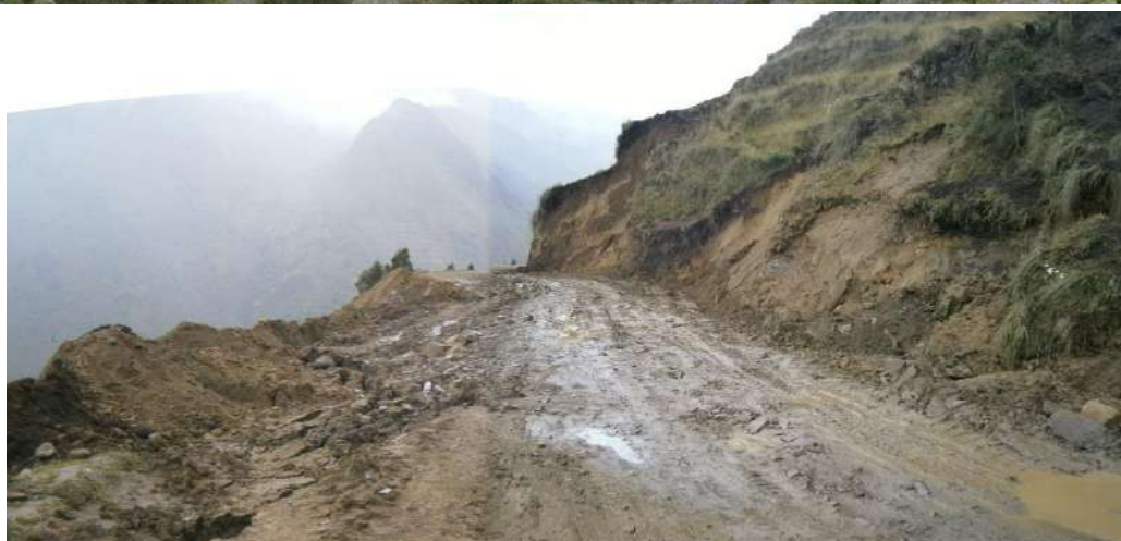
Foto 7.21. Vista panorámica del sector Runatullo asentado sobre un piedemonte coluvio-deluvial del cerro Alfonsito, algunas viviendas del poblado Runatullo se encuentran muy cerca de la zona de arranque de derrumbes cuyo avance es retrogresivo (arriba). En la parte inferior tramo de la carretera Comas-Runatullo afectado por derrumbes y huacos (abajo)
