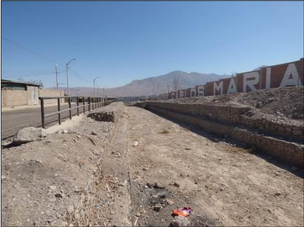
Foto 13. Estructura de gaviones en la quebrada El Cementerio, sector José Carlos Mariátegui.
