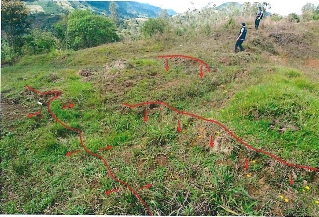
Figura 8: Se observa desplazamientos verticales y agrietamientos a lo largo de la ladera evaluada.
