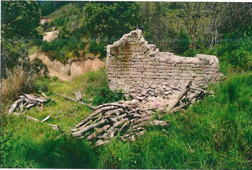
Fotografía 5: Vivienda colapsada a consecuencia del agrietamiento de sus paredes al interior de la vivienda.
