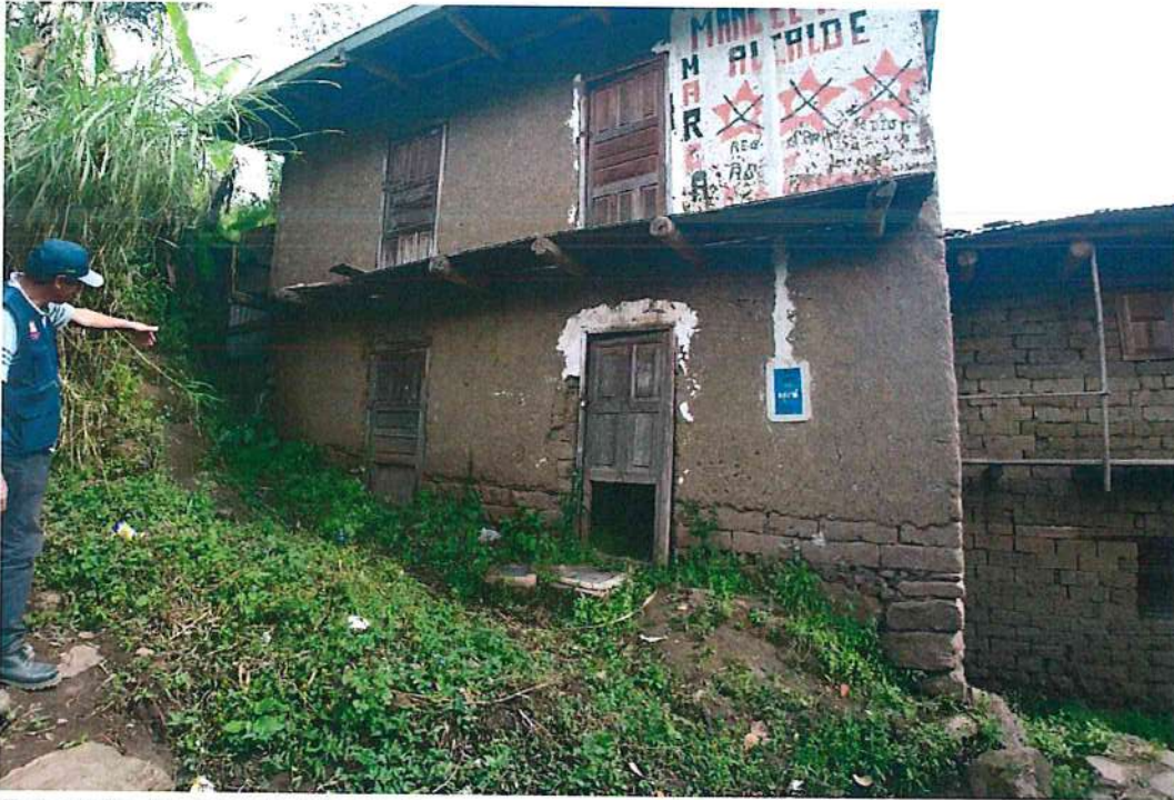
Fotografía 4: vivienda inhabitable a consecuencia del agrietamiento de sus paredes al interior de la vivienda.
