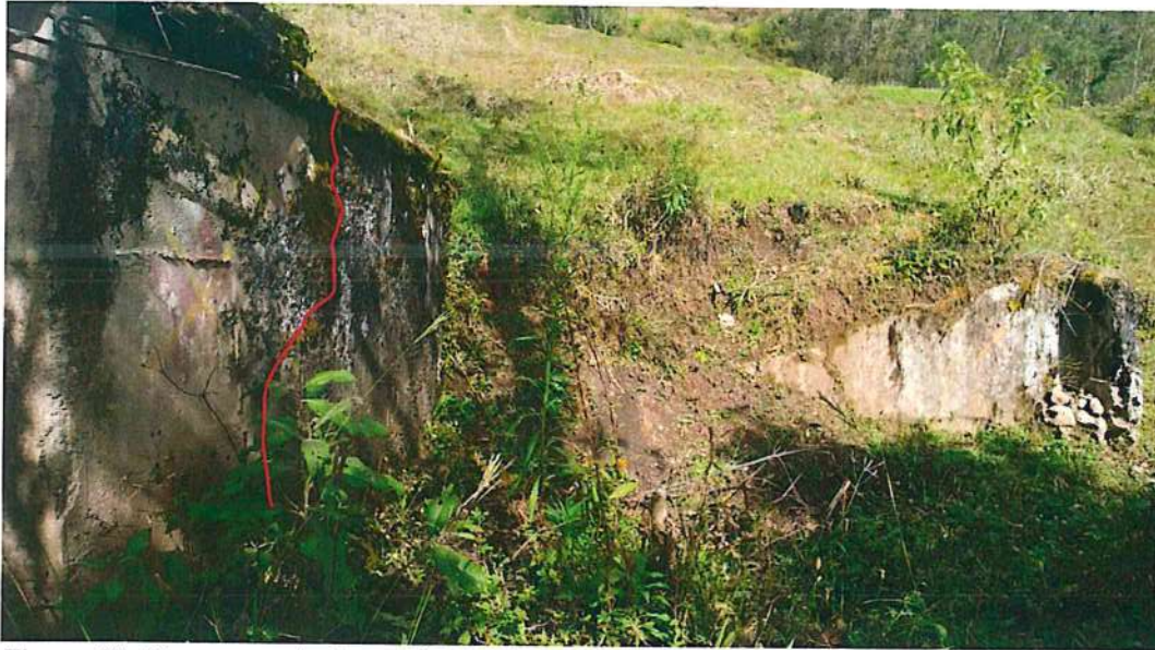
Figura 10: Tanques colectores de agua potable, colapsados como consecuencia de los desplazamientos verticales y agrietamientos del terreno.
