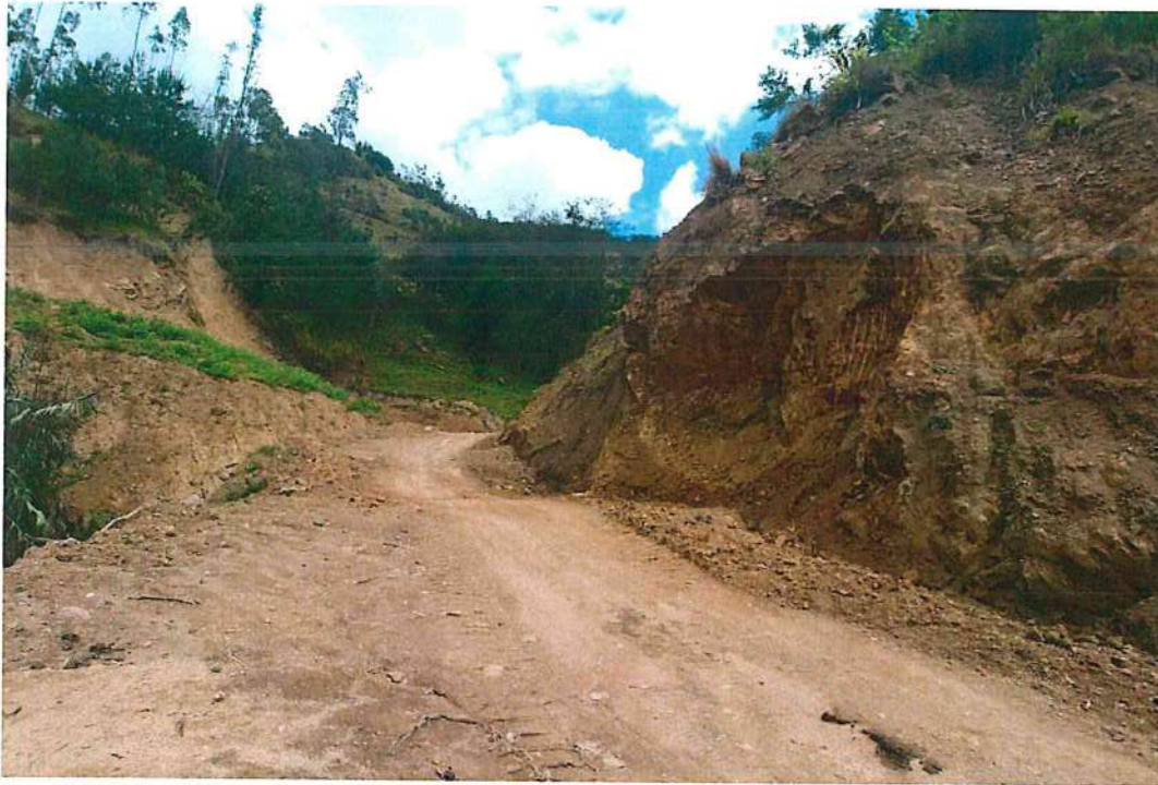
Fotografía 6: Perfilado no adecuado casi vertical en el talud de corte, ocasiona caída de material a la plataforma de la carretera.
