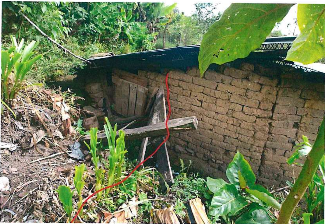
Figura 6: Vivienda inhabitable, debido al agrietamiento en el terreno afectando paredes y piso.
