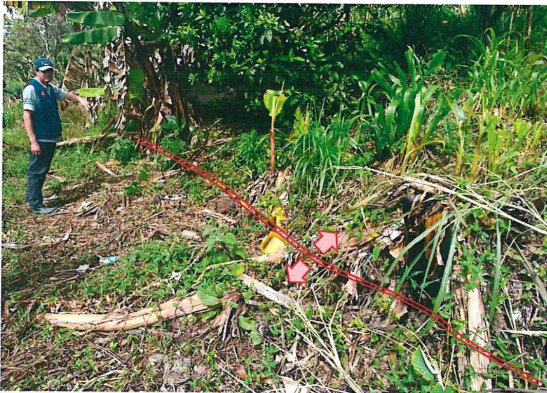
Figura 9: Se observa agrietamiento del terreno en la parte baja de la zona evaluada.
