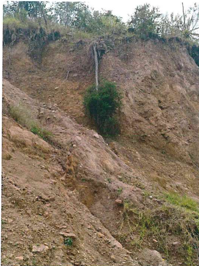
Fotografía 7: Perfilado no adecuado casi vertical en el talud de corte, ocasiona caída de material a la plataforma de la carretera.
