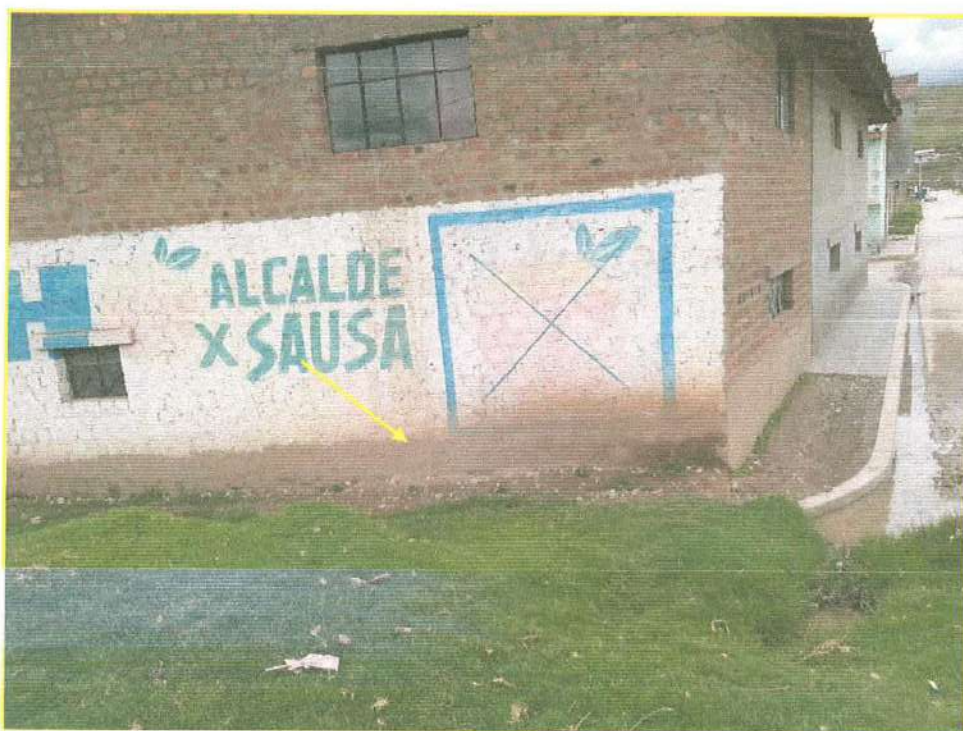
Fotografías 06; vista de viviendas afectadas por el desborde del canal, área EVAR.
