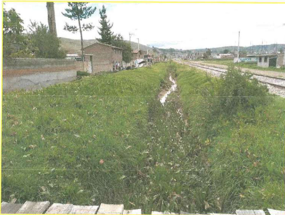
Fotografía 08; vista del canal aguas arriba, viviendas expuestas, área EVAR.
