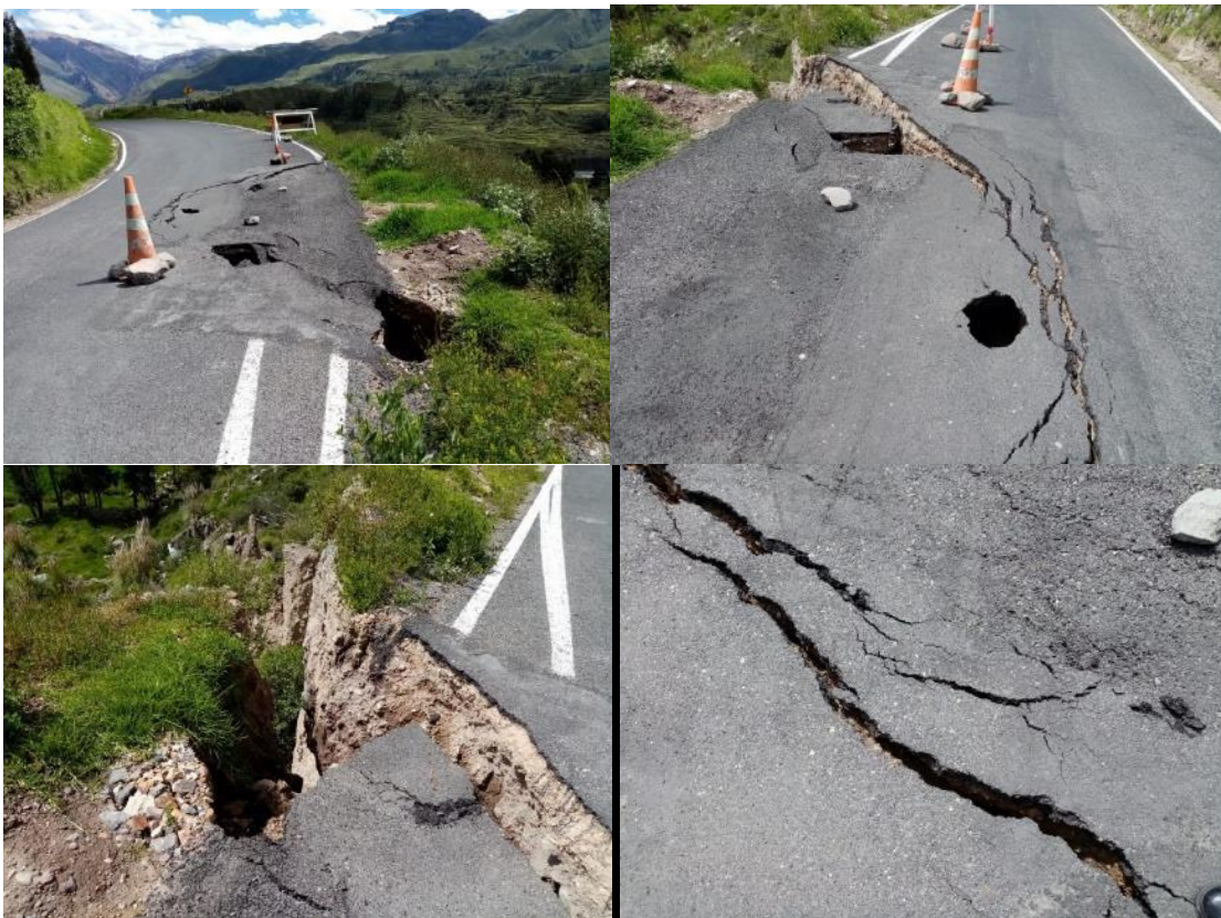
Figura 16. Muestra agrietamientos circulares y hundimientos en el tramo oeste de la carretera Maca – Cabanaconde.
