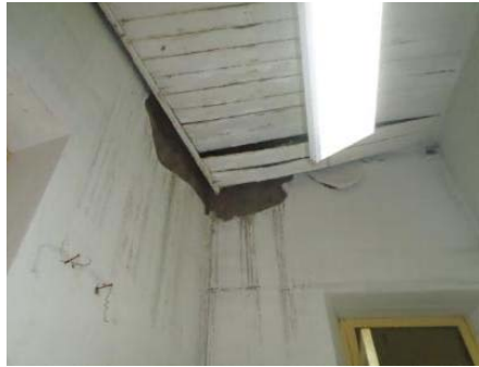
Foto 25 Presencia de riesgo inminente al desplome del techo de madera frente a un sismo, en zona de almacenes.
