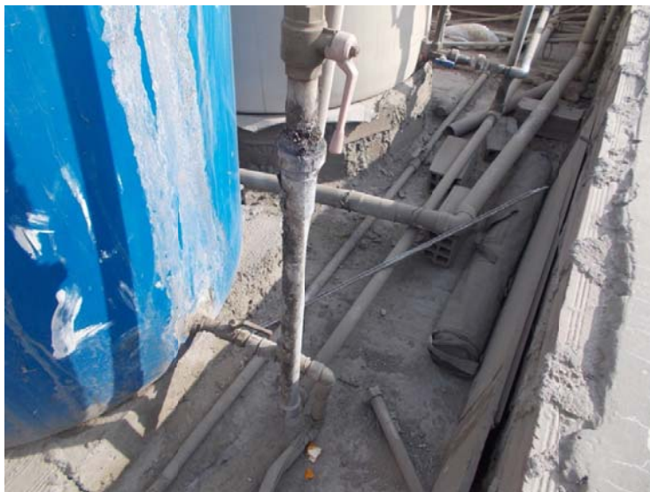
Foto46. Tuberías deterioradas de F°G°
