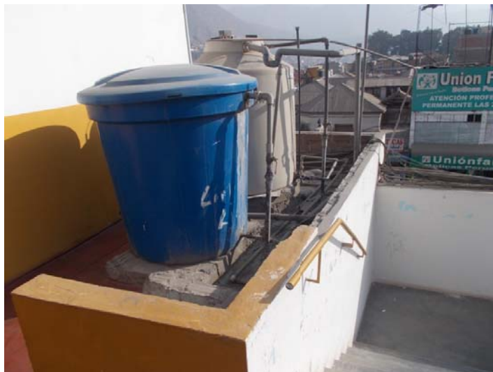
Foto48. Almacenamiento en tanques de Fibra de Vidrio sin anclajes
