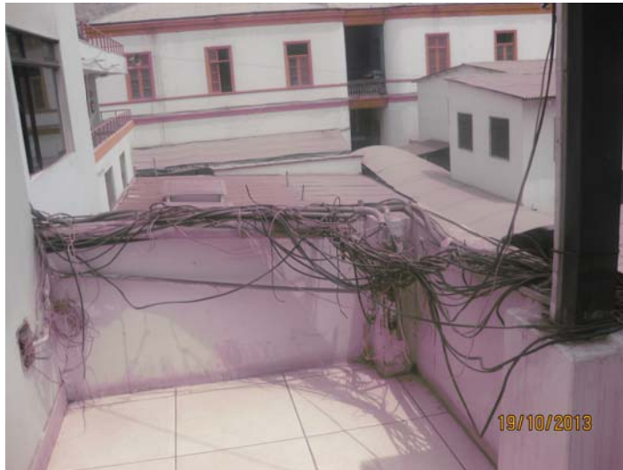
Foto 43. Cables de comunicaciones desordenados
