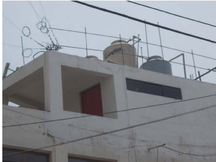
Foto44. Tanques de plástico en techo de hospital
