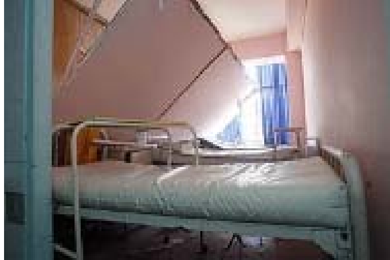
Fig. 4.1 Tabiques no asegurados adecuadamente, corren el riesgo de deformaciones o caídas ante eventos adversos.
