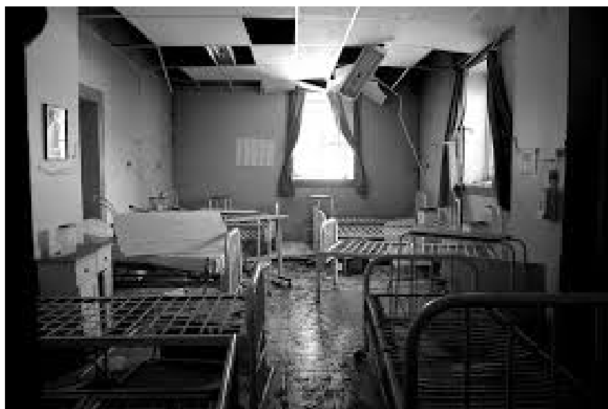
Fig. 4.7 Luminarias no sujetadas adecuadamente en techo ante movimientos sísmos, se caen e incrementan el peso del falso cielo raso provocando colapso del sistema.
