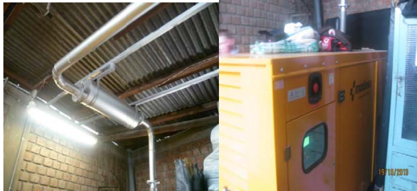
Foto 40. Ambiente del grupo electrógeno
