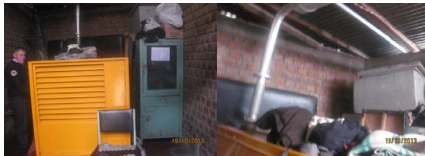
Foto 41. Ambiente inadecuado de Grupo Electrónico
