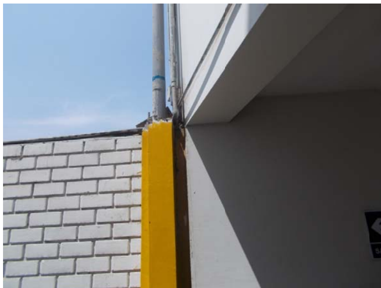
Foto49. Tuberías sin protección al aire libre
